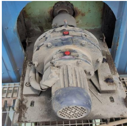
Gambar 3.7 Hopper (Sumber : Dokumentasi di PT Sari Dumai Sejati)
