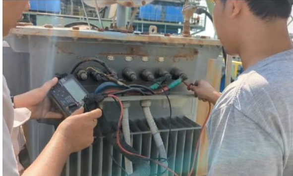
Gambar 4.4 Pemeriksaan Tahanan Trafo Reactifier ESP (Sumber : Dokumentasi PT Sari Dumai Sejati)
