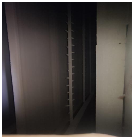
Gambar 3.5 Discharge Electrode Discharge (Sumber : Dokumentasi di PT Sari Dumai Sejati)
