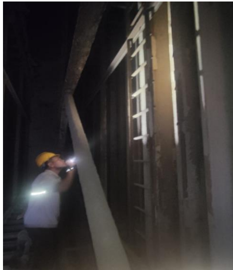
Gambar 4.5 Inspeksi Bagian Dalam ESP (Sumber : Dokumentasi PT Sari Dumai Sejati)
