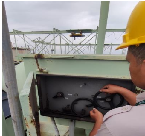
Gambar 4.2 Menggroundingkan Output Trafo Dari ESP (Sumber : Dokumentasi PT Sari Dumai Sejati)
