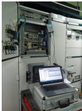
Gambar 2.28 Pengecekan kabel profibus
