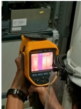
Gambar 2.9Pengecekan Temperature Modul Stater di MCC
