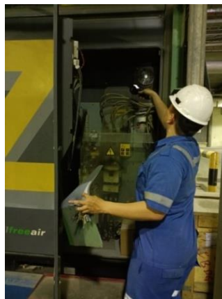
Gambar 2.6 Pengukuran Temperatur Motor compressor Di PM.2 (Sumber: Dokumentasi PT. Riau Andalan Pulp and Paper Pangkalan Kerinci, 2023)
