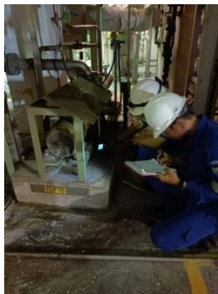
Gambar 2.31 Pengecekan Temperature Motor Listrik
