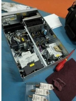
Gambar 2.51 Pengecekan dan Pembersihan Modul Stater di MCC 523 (Sumber: Dokumentasi PT. Riau Andalan Pulp and Paper Pangkalan Kerinci, 2023)
