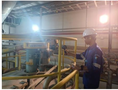
Gambar 2.54 Pengecekan Temperature Motor
