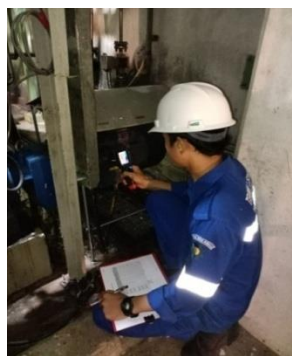
Gambar 2.56 Pengecekan Temperature Motor
