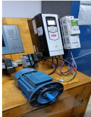
Gambar 2.50 Pengujian Motor 0.75 Kw Menggunakan Drive ABB ACS880 (Sumber: Dokumentasi PT. Riau Andalan Pulp and Paper Pangkalan Kerinci, 2023)
