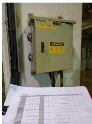
Gambar 2.37 Pengecekan Panel di PM3
