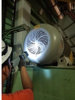
Gambar 2.34 Pengukuran Temperature Dan Pengecekan RPM Motor Listrik
