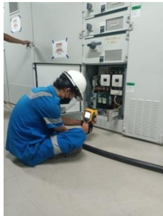
Gambar 2.11 Pengukuran Temperature Pada Modul Stater di MCC PM.2
