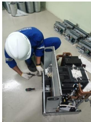
Gambar 2.25 Pengecekan dan pembersihan modul stater
