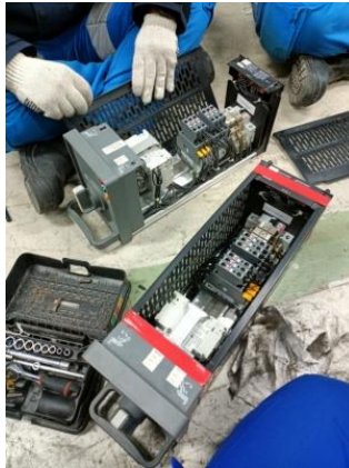
Gambar 2.41 Pengecekan dan Pembersihan Modul Stater
