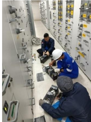
Gambar 2.10 Pembersihan dan Pengecekan Pada Modul Stater di MCC
