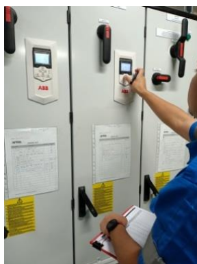
Gambar 2.45 Pengecekan dan Pengambilan Data Drive
