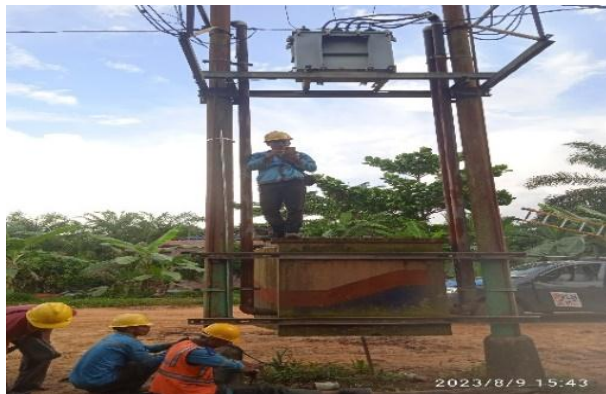
Gambar 3. 11 Gardu Portal (Sumber: Dokumentasi Pribadi 2023)
