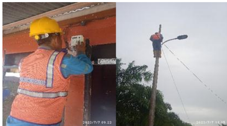
Gambar 2. 22 Penggantian KWH Meter (Sumber: Dokumentasi Pribadi 2023)
