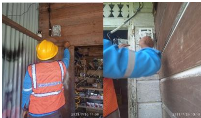
Gambar 2. 33 Penggantian KWH Meter (Sumber: Dokumentasi Pribadi 2023)
