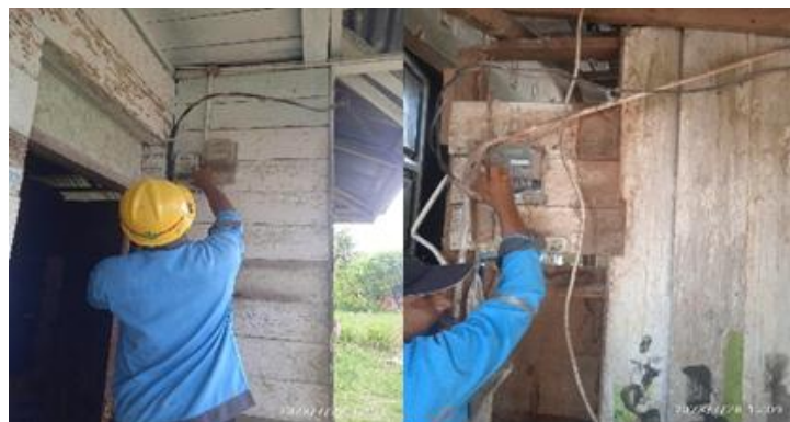
Gambar 2. 35 Memasukkan No CT Pada KWH (Sumber: Dokumentasi Pribadi 2023)
