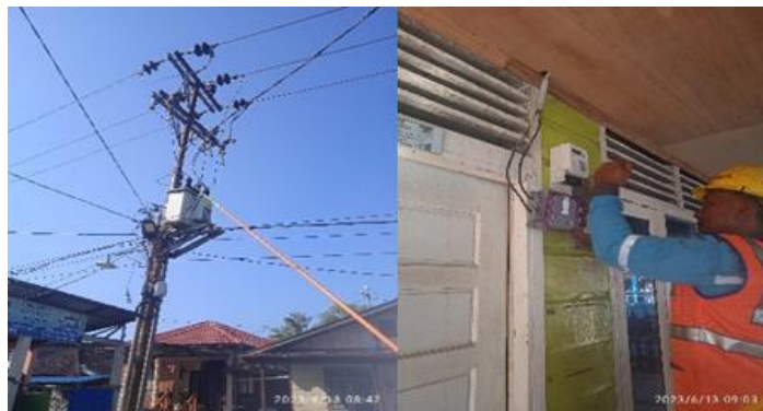
Gambar 2. 6 Mengatasi Gangguan Listrik (Sumber: Dokumentasi Pribadi 2023)
