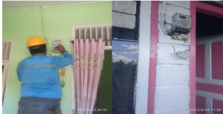
Gambar 2. 10 Memasukkan Nomor CT Pada KWH (Sumber: Dokumentasi Pribadi 2023)
