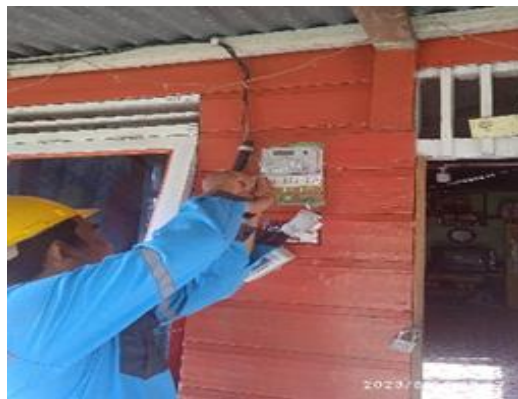
Gambar 2. 44 Penggantian KWH Meter (Sumber: Dokumentasi Pribadi 2023)
