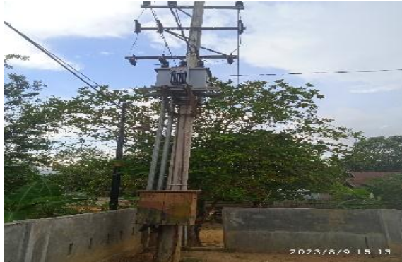
Gambar 3. 10 Gardu Cantol (Sumber: Dokumentasi Pribadi 2023)
