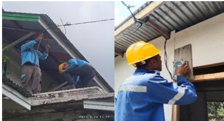
Gambar 2. 51 Mengatasi Gangguan Listrik (Sumber: Dokumentasi Pribadi 2023)
