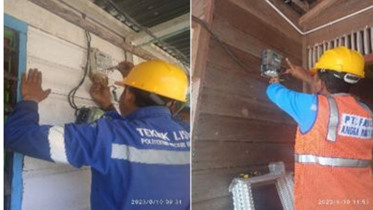
Gambar 2. 42 Penggantian KWH meter (Sumber: Dokumentasi Pribadi 2023)
