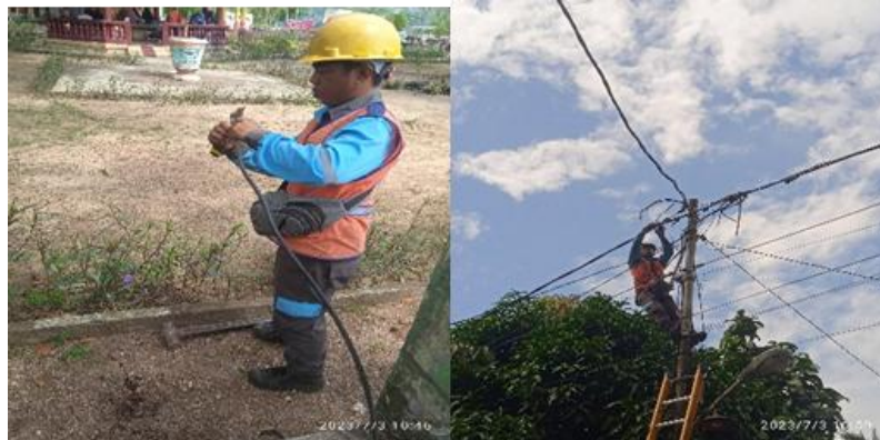
Gambar 2. 18 Mengatasi Gangguan Listrik (Sumber: Dokumentasi Pribadi 2023)
