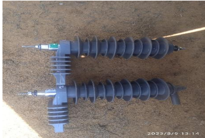
Gambar 3. 9 Lightning Arrester (LA) (Sumber: Dokumentasi Pribadi 2023)
