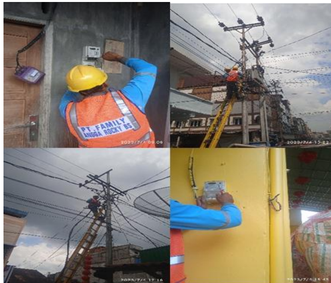
Gambar 2. 19 Penggantian KWH Meter (Sumber: Dokumentasi Pribadi 2023)
