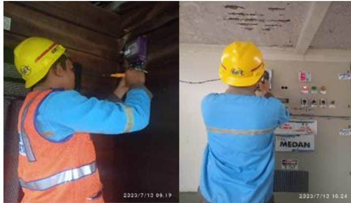
Gambar 2. 26 Penggantian KWH meter (Sumber: Dokumentasi Pribadi 2023)
