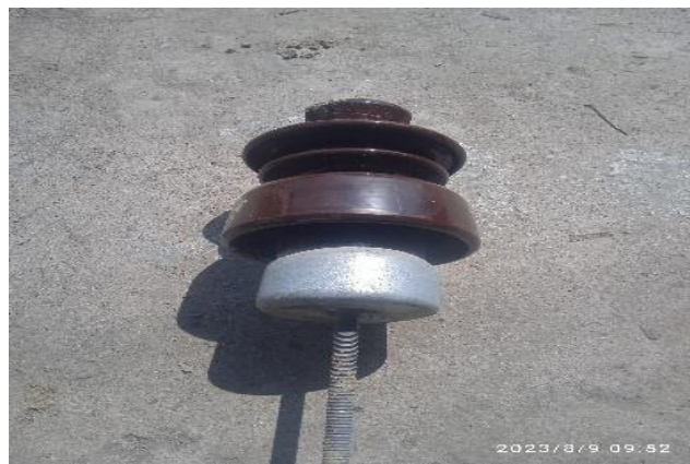
Gambar 3. 6 Isolator Tumpu (Sumber: Dokumentasi Pribadi 2023)
