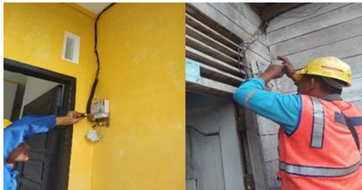
Gambar 2. 46 Penggantian KWH Meter (Sumber: Dokumentasi Pribadi 2023)
