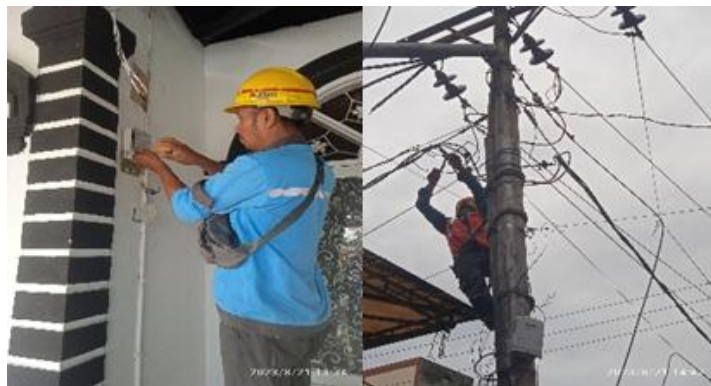
Gambar 2. 49 Mengatasi Gangguan Listrik (Sumber: Dokumentasi Pribadi 2023)
