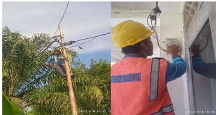
Gambar 2. 38 Mengatasi Gangguan Listrik (Sumber: Dokumentasi Pribadi 2023)
