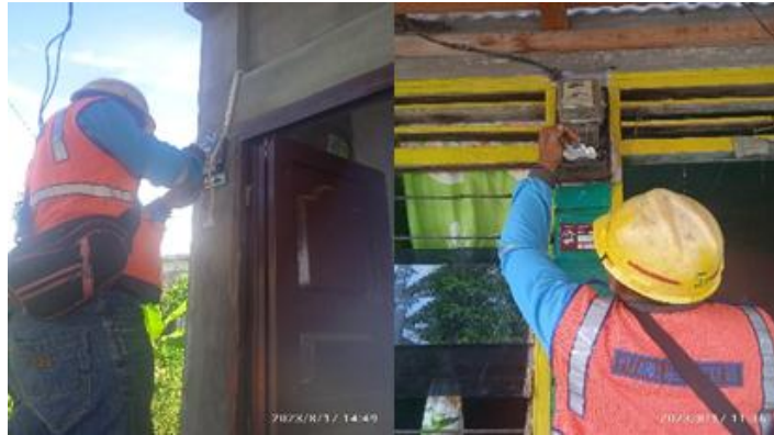
Gambar 2. 47 Mengatasi Gangguan Listrik (Sumber: Dokumentasi Pribadi 2023)
