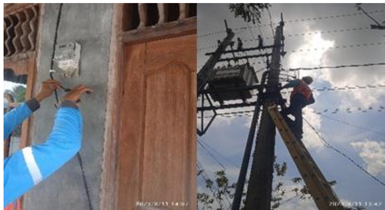
Gambar 2. 43 Mengatasi Gangguan Listrik (Sumber: Dokumentasi Pribadi 2023)
