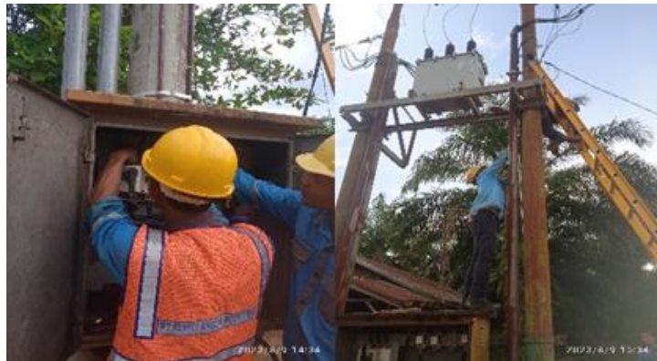
Gambar 2. 41 Pemeliharaan PHBTR (Sumber: Dokumentasi Pribadi 2023)
