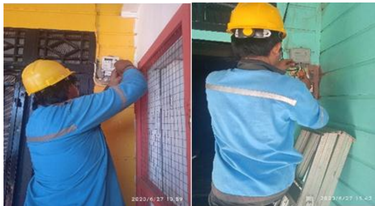
Gambar 2. 16 Penggantian KWH Meter (Sumber: Dokumentasi Pribadi 2023)
