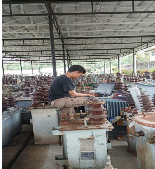
Gambar 2.31 mendata trafo rusak.
