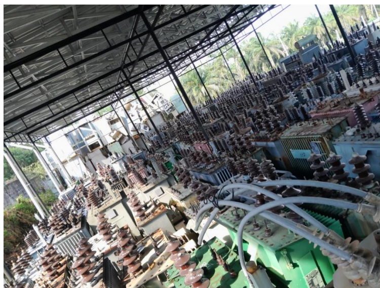
Gambar 2.30 gudang trafo distribusi.
