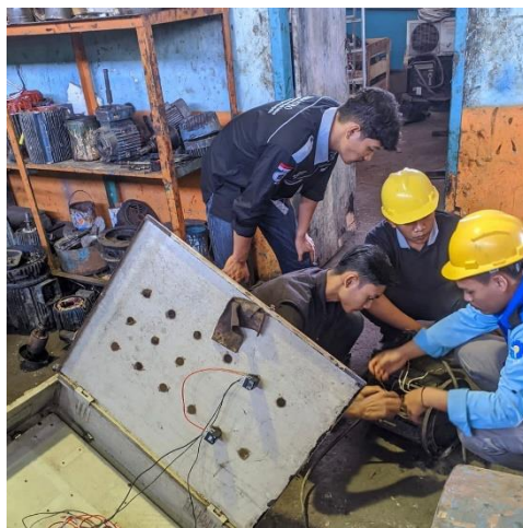
Gambar 2. 8 Mengetes Motor Induksi 3 Phasa (Sumber: Dokumentasi di PT. Perkebunan Nusantara V)
