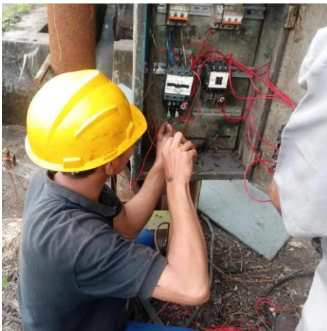
Gambar 2. 68 Memperbaiki Panel Kontrol (Sumber: Dokumentasi di PT. Perkebunan Nusantara V)
