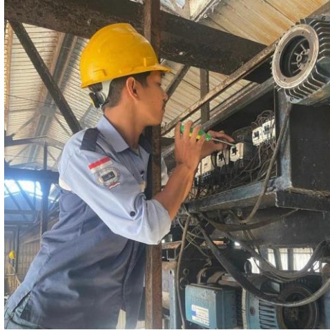
Gambar 2. 17 Pengecekan Kontaktor (Sumber: Dokumentasi di PT. Perkebunan Nusantara V)
