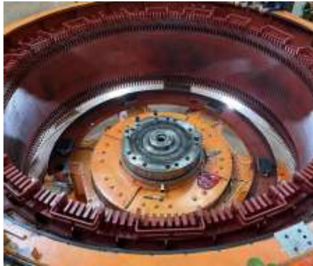
Gambar 3.7 Stator pada ULPLTA Koto Panjang (Sumber : Arsip Perusahaan)
