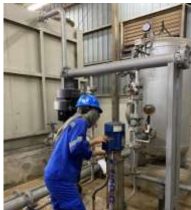
Gambar 2.11 Pengecekan Pompa Filter
