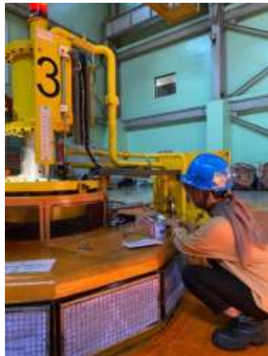
Gambar 2.7 Pengecekan Slip Ring Unit 3
