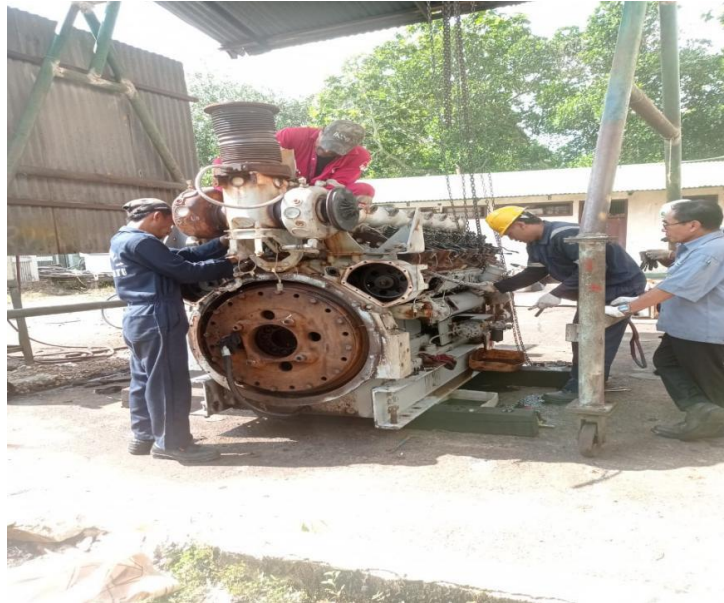
Gambar 4. 1 Proses Pemeliharaan Oli atau Pelumas Mesin Gas Engine Caterpillar 3512 (Sumber: Dokumentasi Pribadi)
