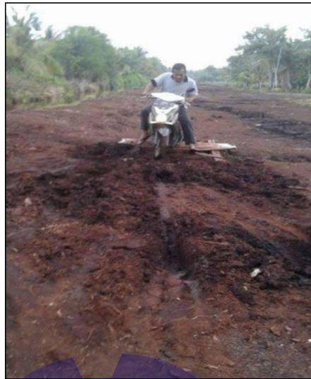
Gambar 1.1 Gambar Jalan Parit Tugu Sebelum Peningkatan
