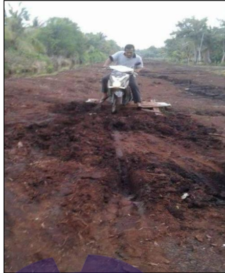
Gambar 1.1 Gambar Jalan Parit Tugu Sebelum Peningkatan
