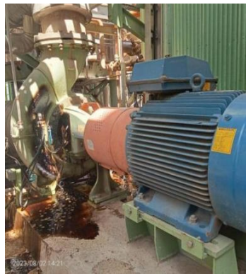
Gambar 4.23 Kebocoran pada pompa Sumber : Como RPL Office, PT. RAP
