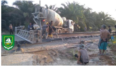
Gambar 3. 6 Truk Mixer Sumber : Dokumentasi KP,2023
