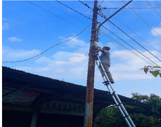
Gambar 3. 3 Pengecekan ODP pole
