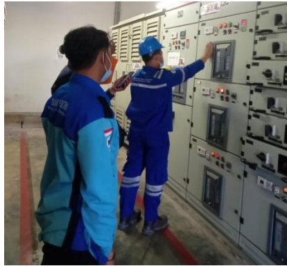
Gambar 2.17 monitoring panel breker (Sumber : Dokumentasi 2023)
