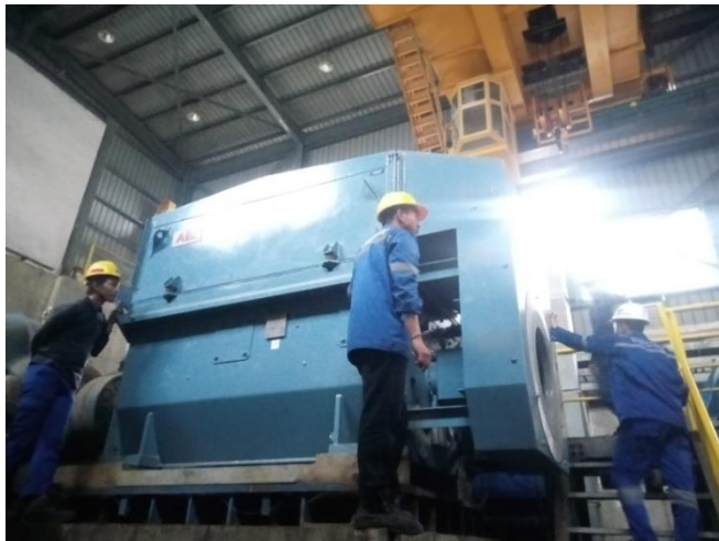
Gambar 2.11 Pengecekan Motor 6000 KV (Sumber : Dokumentasi 2023)
