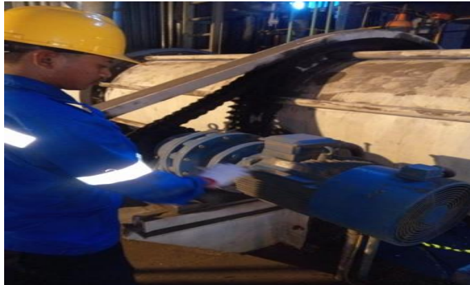
Gambar 2.27 PM PLTU ROTARY COOLER BOTTOM ASH EL-28D (Sumber: Dokumentasi 2023)
