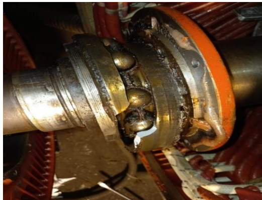
Gambar 3.6 Kondisi Bearing pecah (Sumber: Dokumetasi 2023)
