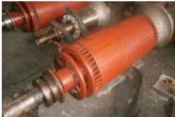
Gambar 3.15 Kondisi Rotor setelah Overhaul (Sumber: Dokumentasi 2013)
