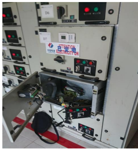
Gambar 3.7 Kondisi Kontrol panel pada saat pengecekan terkoneksi nya 2 fasa (Sumber : Dokumetasi 2023)
