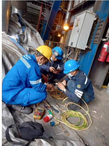
Gambar 2.15 Support power 3 fasa (Sumber : Dokumentasi 2023)
