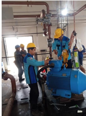
Gambar 2.23 Pembukaan terminal motor 3 fasa (Sumber : Dokumentasi 2023)
