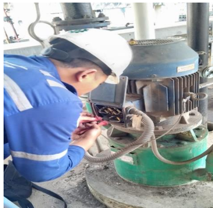
Gambar 2.1 pengecekan kerusakan motor induksi 3 fasa (Sumber : Dokumentasi 2023)
