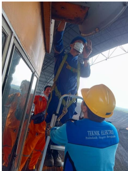
Gambar 2.16 Pergantian lampu SR ( stacker Reakleimer ) (Sumber : Dokumentasi 2023)
