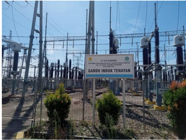
Gambar 1.2 Gardu Induk PT PLN NP UP Tenayan (Sumber: Dokumentasi 2023)
