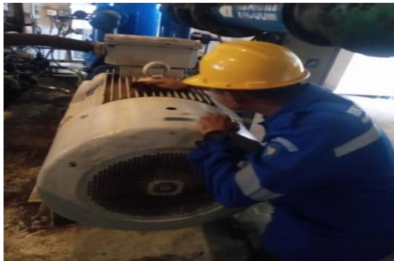
Gambar 2.28 PM PLTU ROTARY COOLER BOTTOM ASH EL-28D (Sumber: Dokumentasi 2023)
