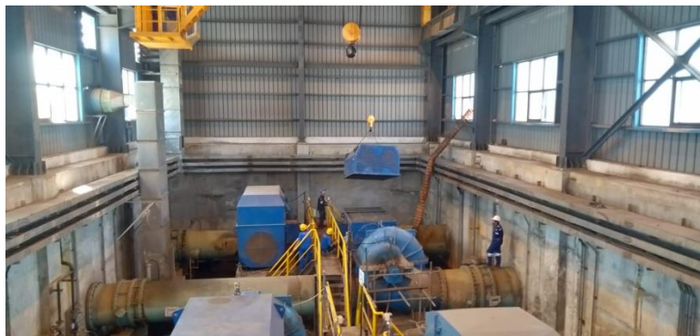
Gambar 2.7 Change Over Coller (Sumber : Dokumentasi 2023)
