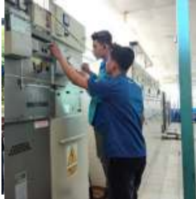
Gambar 2.4 Kegiatan monitoring KWH setiap jamnya (Sumber: PT. Megapower Makmur Tbk, 2023)
