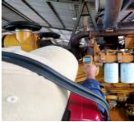
Gambar 2.24 Kegiatan monitoring KWH setiap jamnya (Sumber: PT. Megapower Makmur Tbk, 2023)
