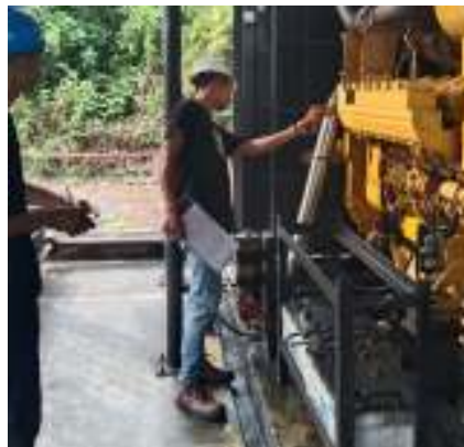
Gambar 2.44 Kegiatan monitoring KWh setiap jamnya (Sumber: PT. Megapower Makmur Tbk, 2023)
