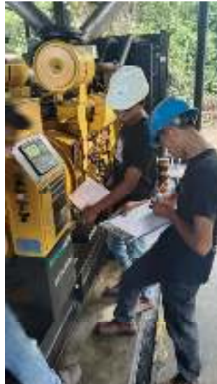
Gambar 2.40 Kegiatan monitoring KWH setiap jamnya (Sumber: PT. Megapower Makmur Tbk, 2023)
