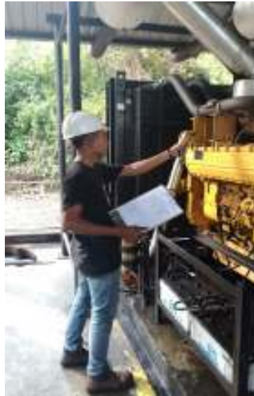
Gambar 2.22 Kegiatan monitoring KWH setiap jamnya (Sumber: PT. Megapower Makmur Tbk, 2023)
