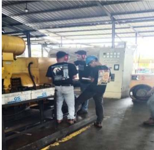
Gambar 2.10 Kegiatan monitoring KWH setiap jamnya (Sumber: PT. Megapower Makmur Tbk, 2023)
