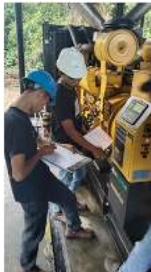
Gambar 2.3 Kegiatan monitoring KWH setiap jamnya (Sumber: PT. Megapower Makmur Tbk, 2023)
