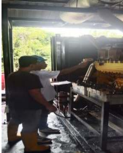
Gambar 2.30 Kegiatan monitoring KWH setiap jamnya (Sumber: PT. Megapower Makmur Tbk, 2023)
