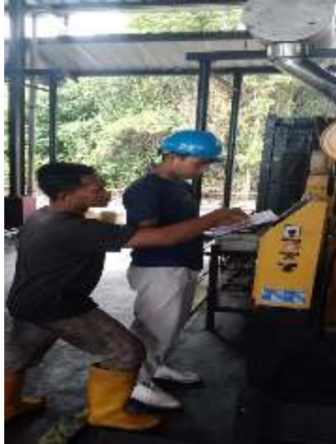
Gambar 2.15 Kegiatan monitoring KWH setiap jamnya (Sumber: PT. Megapower Makmur Tbk, 2023)
