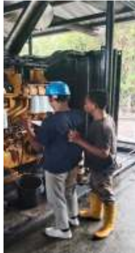
Gambar 2.34 Kegiatan monitoring KWH setiap jamnya (Sumber: PT. Megapower Makmur Tbk, 2023)
