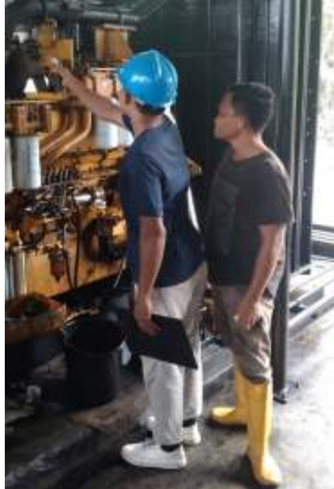
Gambar 2.17 Kegiatan monitoring KWH setiap jamnya (Sumber: PT. Megapower Makmur Tbk, 2023)
