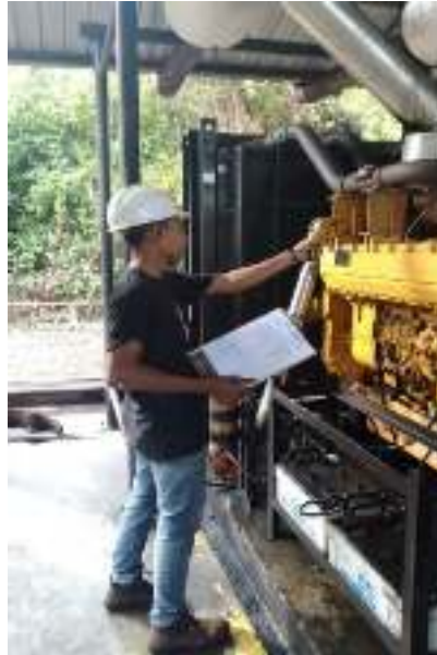
Gambar 2.2 Kegiatan monitoring KWH setiap jamnya (Sumber: PT. Megapower Makmur Tbk, 2023)
