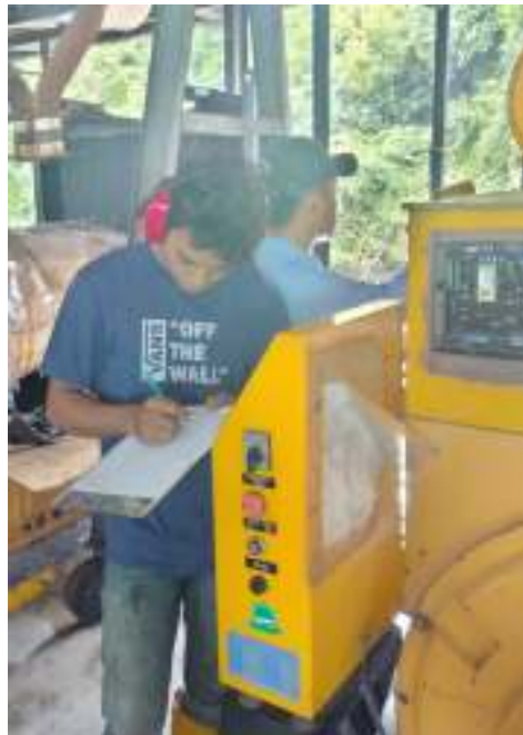
Gambar 2.25 Kegiatan monitoring KWH setiap jamnya (Sumber: PT. Megapower Makmur Tbk, 2023)
