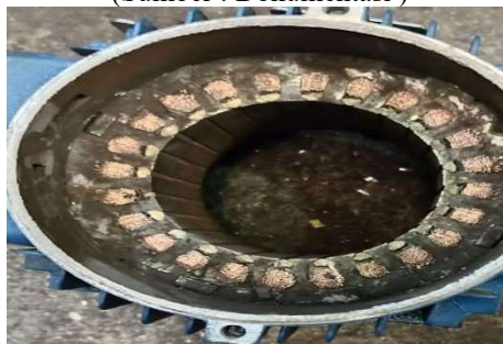
Gambar 4.18 Coil Rusak (Sumber : Dokumentasi )
