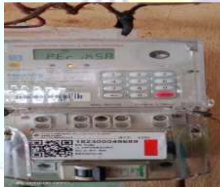
Gambar 2.22 Kwh Tertera Periksa di rumah Pelanggan ( Sumber :PLN. Rayon bengkalis PT. Adra gemilang.2020)
