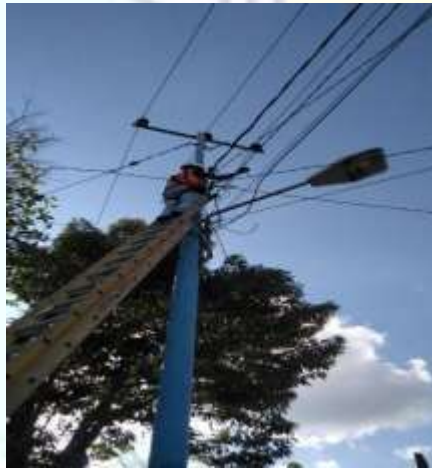
Gambar 2.11 Kabel SR kendor/ putus yang di akibatkan pohon tumbang ( Sumber :PLN. Rayon bengkalis PT. Adra gemilang,2020)
