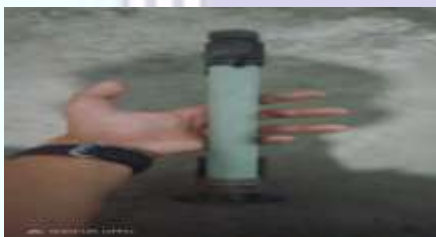
Gambar 2.9 fuse link CO ( cut out ) yang putus akibat adanya gangguan pada JTM
