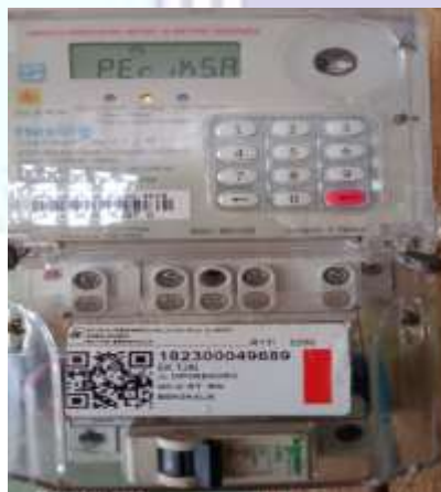
Gambar 2.17 Kwh meter periksa
