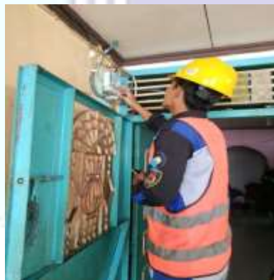
Gambar 2.15 Kwh meter periksa
