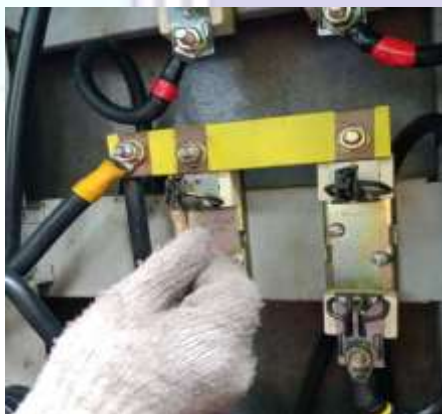
Gambar 2.7 Perawatan PHB-TR (Perangkat Hubung Bagi Tegangan Rendah) ( Sumber :PLN. Rayon bengkalis PT. Adra gemilang.2020)
