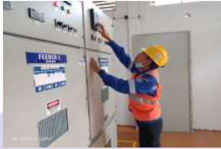
Gambar 2.4 Melihat secara langsung cara kerja feeder ( Sumber :PLN. Rayon bengkalis PT. Adra gemilang.2020)
