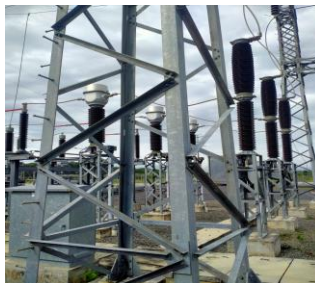
Gambar 2.9 Pengecekan switchgear pada gardu induk WINA (sumber:dokumentasi penulis,2023)
