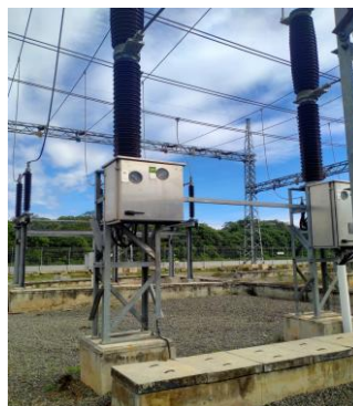
Gambar 2.12 Pengecekan Switchgear Pada Gardu Induk WINA (sumber:dokumentasi penulis,2023)
