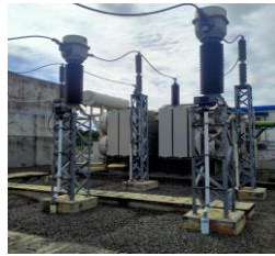
Gambar 2.13 Pengecekan Switchgear pada gardu induk WINA (sumber:dokumentasi penulis,2023)
