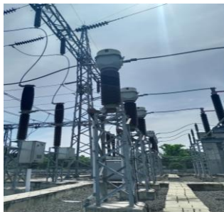
Gambar 2.7 Current Transformer (sumber:dokumentasi penulis,2023)
