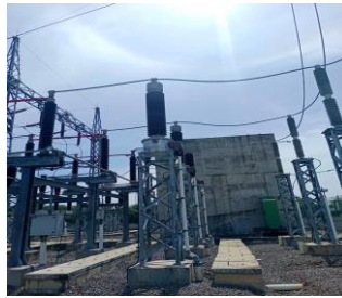
Gambar 2.6 Capacitive Voltage Transformer (sumber:dokumentasi penulis,2023)
