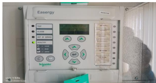
Gambar 2.16 micom p142 pada gardu induk WINA (sumber:dokumentasi penulis,2023)
