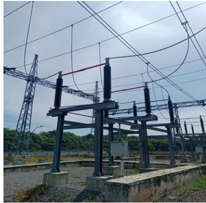
Gambar 2.10 Disconnecting Switch (sumber:dokumentasi penulis,2023)
