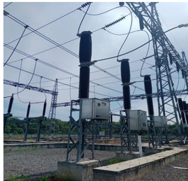
Gambar 2.8 Circuit Breaker (sumber:dokumentasi penulis,2023)
