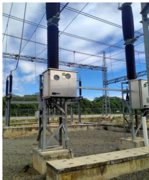
Gambar 2.11 Pengecekan switchgear pada gardu induk WINA (sumber:dokumentasi penulis,2023)
