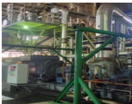
Gambar 3. 16 Turbin Uap Sumber (Dokumentasi 2023)
