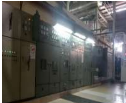
Gambar 2. 39 Maintenance di Kamar Mesin Sumber : Dokumentasi 2023
