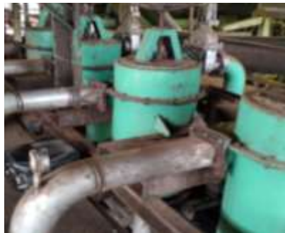
Gambar 2. 45 Pemeriksaan elektromotor di Stasiun Hydroclone Sumber : Dokumentasi 2023
