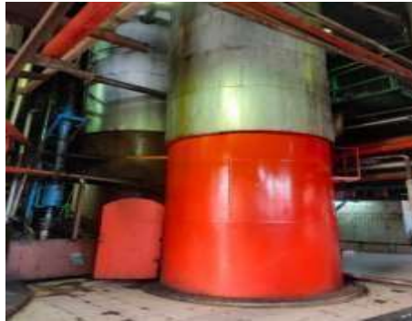
Gambar 3. 8 Oil Tank dan Sludge Tank Sumber : Dokumentasi 2023
