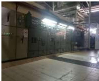
Gambar 2. 31 Monitoring stasiun kamar mesin Sumber : Dokumentasi 2023
