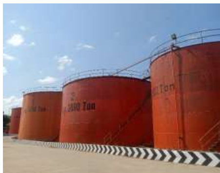
Gambar 3. 12 Storage Tank Sumber(dokumentasi 2023)
