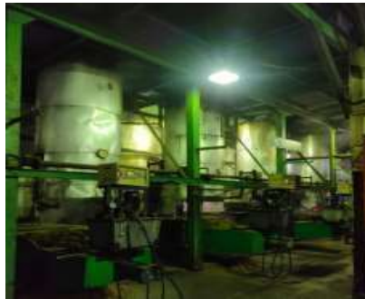
Gambar 2. 5 Stasiun Press Sumber : Dokumentasi 2023
