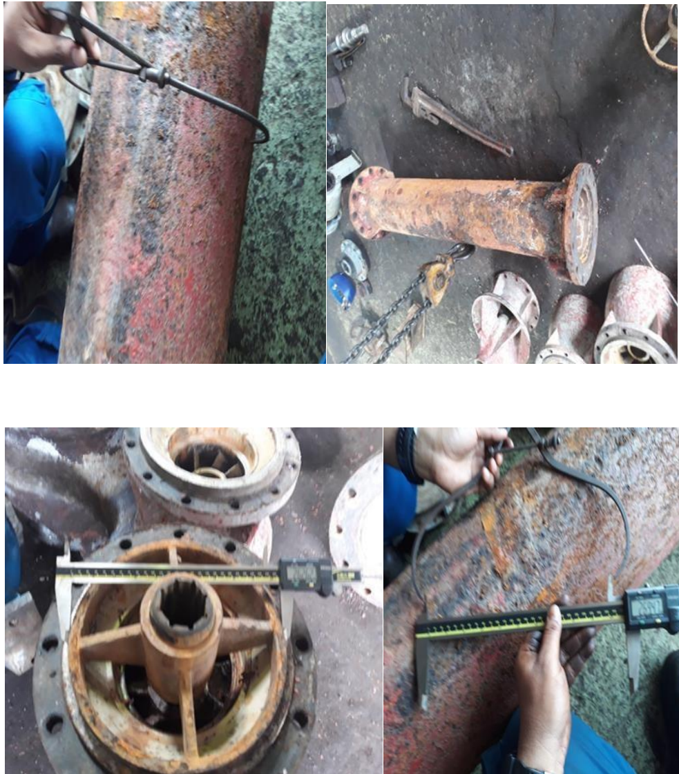
Gambar 4.92 Inspeksi Kerusakan Material
