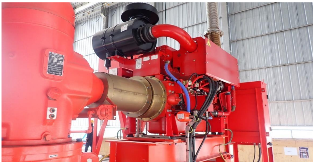
Gambar 4.1 FIRE PUMP 717-PE-3 (Sumber :dokumentasi pribadi)
