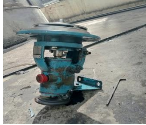
Gambar 4.6 pompa sentrifugal (Sumber dokumen: Pribadi)
