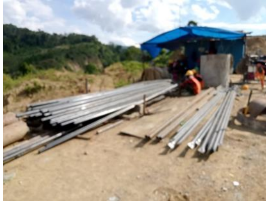
Gambar 4. 15 Pipa CSL Sumber: Dokumentasi Kerja Praktek, 2023
