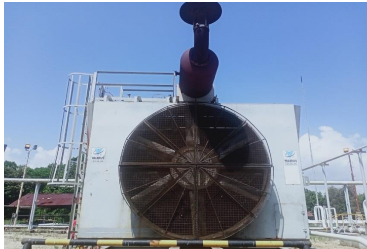
Gambar 4. 8 Radiator (Sumber : Dokumentasi Pribadi)
