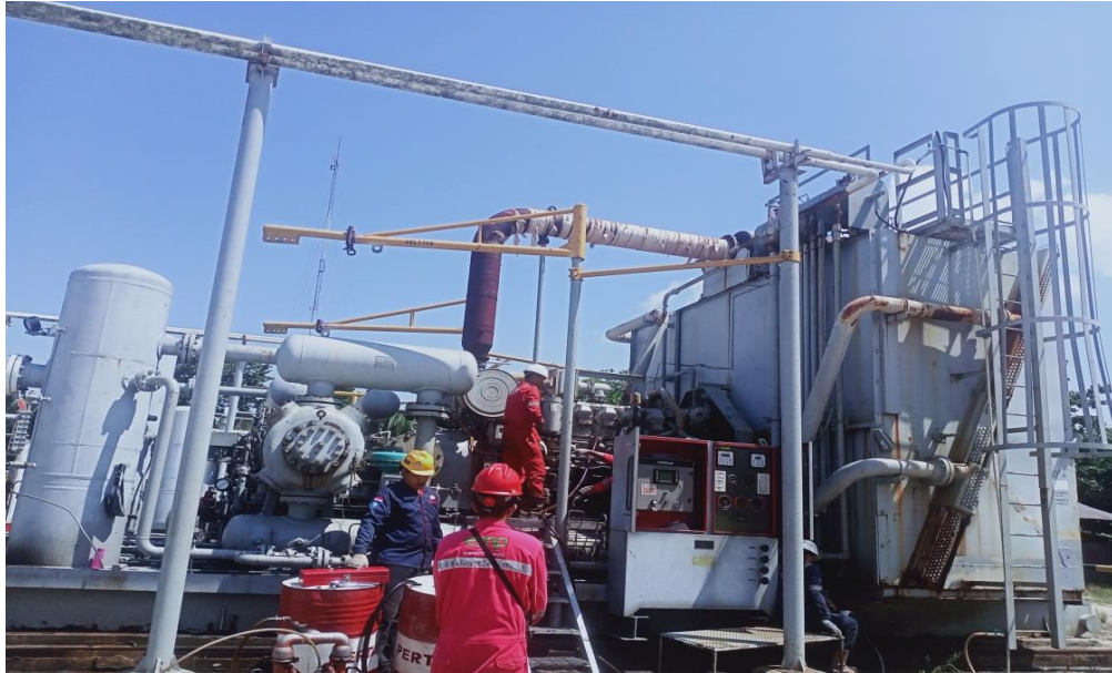
Gambar 4. 1 Gas Engine Compressor (Sumber : dokumentasi pribadi)
