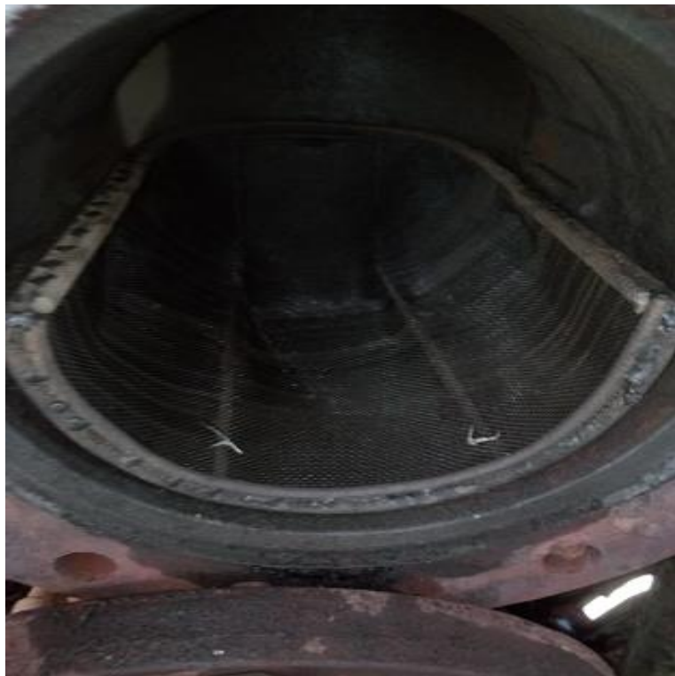
Gambar 4.11 Kerusakan pada Strainer (Sumber: Dokumentasi Pribadi)
