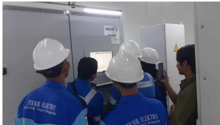
Gambar 2.6 Pengenalan Pulp Dryer dan ke MCC
