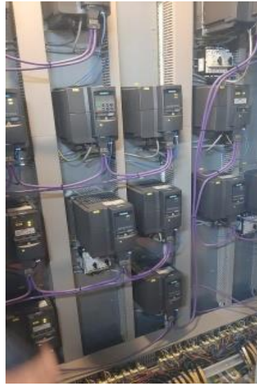
Gambar 2.10 Pengecekan Parameter Motor
