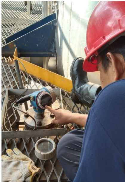
Gambar 2.2 Level Transmitter (Sumber : Dokumentasi penulis,2023)
