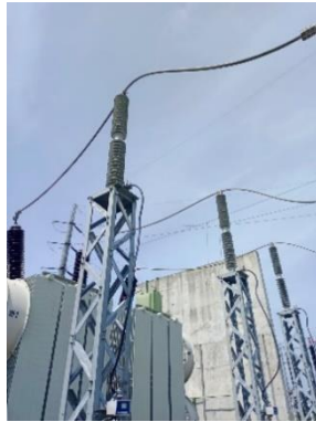
Gambar 3. 2 Lightning Arrester (Sumber : Dokumentasi, 2023)
