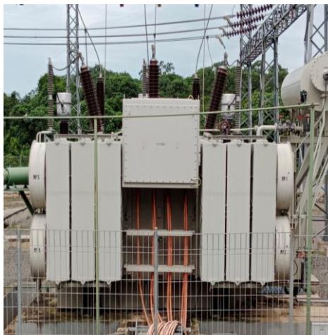
Gambar 3. 8 Transformator Daya 150KV/20KV (Sumber : Dokumentasi, 2023)
