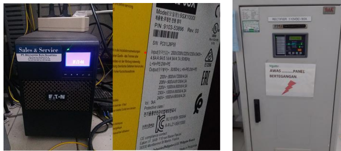
Gambar 2. 9 Rectifier Gardu Induk Wina (Sumber : Dokumentasi, 2023)
