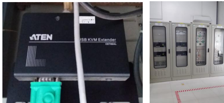
Gambar 2. 10 Marshalling Kiosk Gardu Induk (Sumber : Dokumentasi, 2023)
