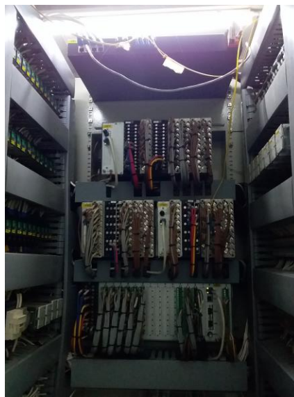
Gambar 4. 2 Panel RTU (Sumber : Dokumentasi, 2023)
