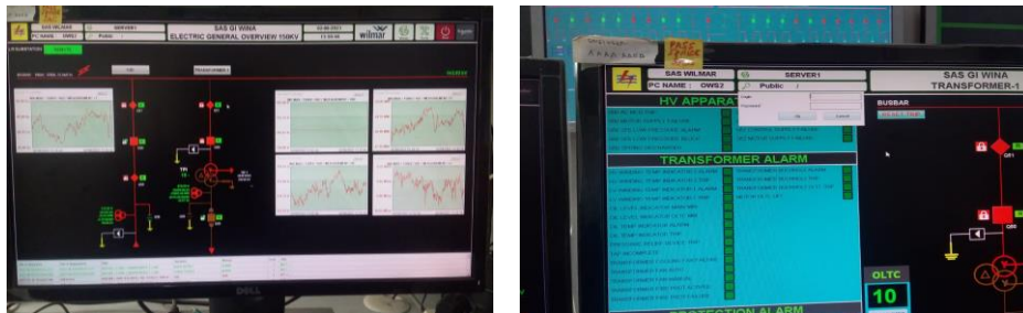
Gambar 2. 8 Tampilan HMI Gardu Induk (Sumber : Dokumentasi, 2023)
