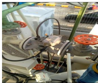
Gambar 3. 12 Relay Buchholz (Sumber : Dokumentasi, 2023)
