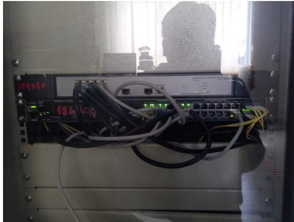
Gambar 4. 4 Ethernet Switch Menggunakan Fiber Optic (Sumber : Dokumentasi, 2023)
