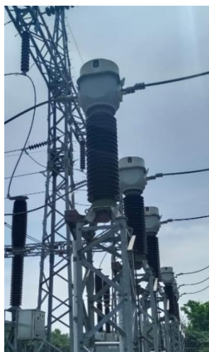
Gambar 3. 5 Current Transformer (Sumber : Dokumentasi, 2023)
