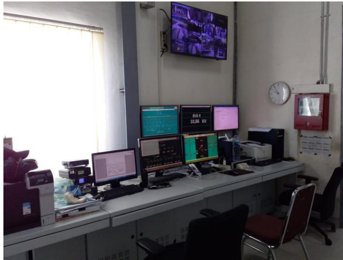
Gambar 4. 3 Control Room (Sumber : Dokumentasi, 2023)
