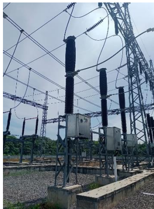
Gambar 3. 6 Circuit Breaker (Sumber : Dokumentasi, 2023)
