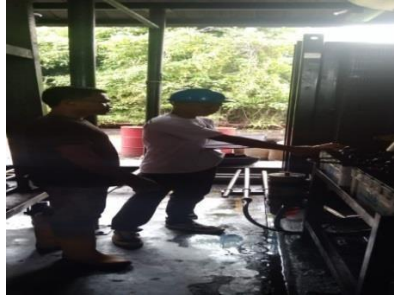
Gambar 2.34 Kegiatan monitoring KWH setiap jamnya sumber: PT. Megapower Makmur Tbk, 2023
