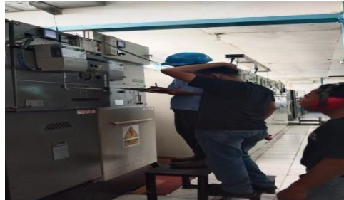
Gambar 2.16 Kegiatan monitoring KWH setiap jamnya (Sumber: PT. Megapower Makmur Tbk, 2023)
