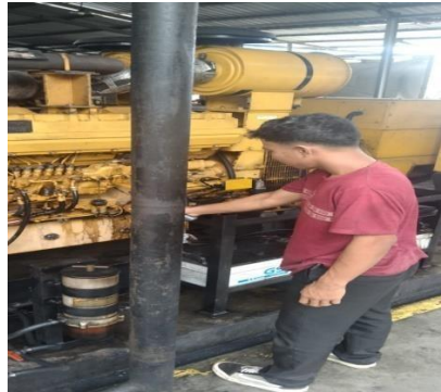
Gambar 2.40 Kegiatan monitoring KWH setiap jamnya (Sumber: PT. Megapower Makmur Tbk, 2023)
