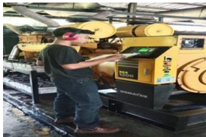
Gambar 2.3 Kegiatan monitoring KWH setiap jamnya ( Sumber : PT. Megapower Makmur Tbk, 2023)
