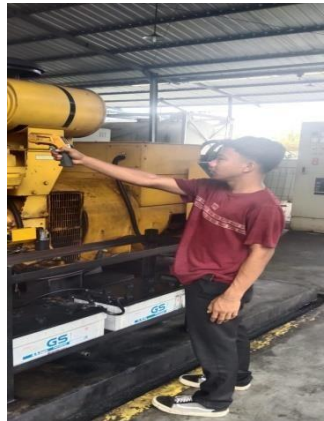
Gambar 2.38 Kegiatan monitoring KWH setiap jamnya (Sumber: PT. Megapower Makmur Tbk, 2023)
