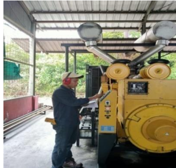
Gambar 2.28 Kegiatan monitoring KWh setiap jamnya (Sumber: PT. Megapower Makmur Tbk, 2023)
