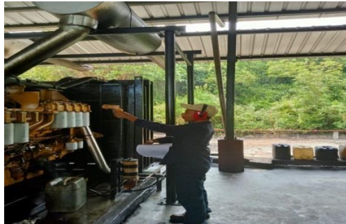
Gambar 2.25 Kegiatan monitoring KWH setiap jamnya (Sumber: PT. Megapower Makmur Tbk. 2023)
