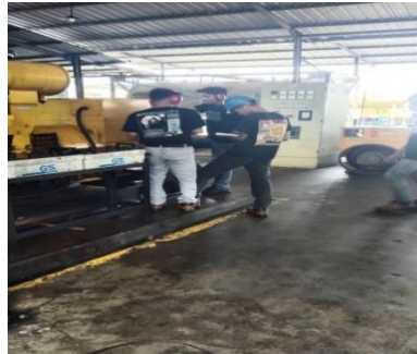
Gambar 2.10 Kegiatan monitoring KWH setiap jamnya (Sumber: PT. Megapower Makmur Tbk, 2023)
