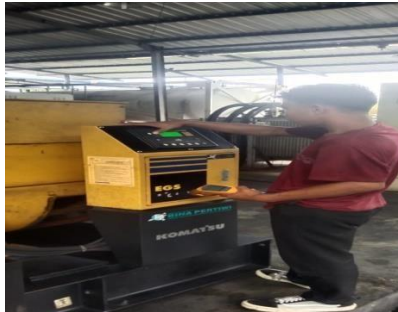
Gambar 2.46 Kegiatan monitoring KWh setiap jamnya (Sumber: PT. Megapower Makmur Tbk, 2023)
