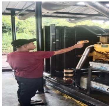
Gambar 2.29 Kegiatan monitoring KWh setiap jamnya (Sumber: PT. Megapower Makmur Tbk, 2023)
