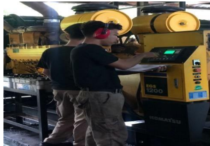
Gambar 2.17 Kegiatan monitoring KWH setiap jamnya (Sumber: PT. Megapower Makmur Tbk, 2023)
