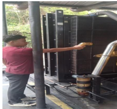
Gambar 2.41 Kegiatan monitoring KWH setiap jamnya (Sumber: PT. Megapower Makmur Tbk, 2023)
