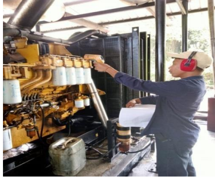
Gambar 2.22 Kegiatan monitoring KWH setiap jamnya (Sumber: PT. Megapower Makmur Tbk, 2023)
