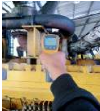
Gambar 2.28 Kegiatan monitoring KWH setiap jamnya (Sumber: PT. Megapower Makmur Tbk, 2023)
