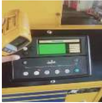
Gambar 2.42 Kegiatan monitoring KWH setiap jamnya (Sumber: PT. Megapower Makmur Tbk, 2023)
