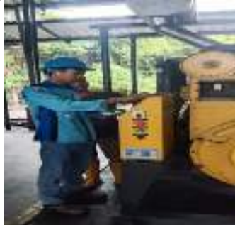
Gambar 2.34 Kegiatan monitoring KWH setiap jamnya (sumber: PT. Megapower Makmur Tbk, 2023)
