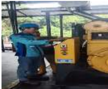
Gambar 2.46 Kegiatan monitoring KWH setiap jamnya (Sumber: PT. Megapower Makmur Tbk, 2023)
