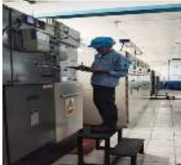
Gambar 2.38 Kegiatan monitoring KWH setiap jamnya (Sumber: PT. Megapower Makmur Tbk, 2023)
