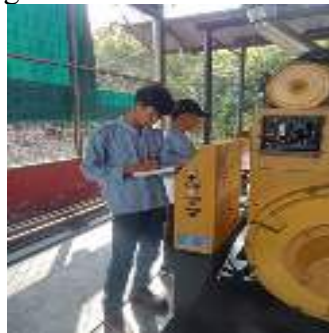
Gambar 2.40 Kegiatan monitoring KWH setiap jamnya (Sumber: PT. Megapower Makmur Tbk, 2023)
