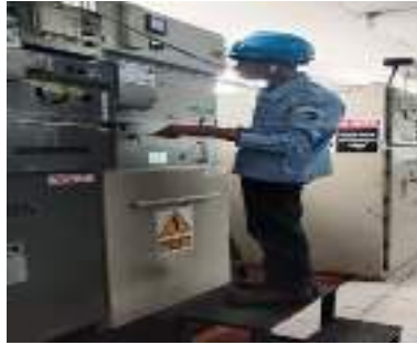
Gambar 2.45 Kegiatan monitoring KWH setiap jamnya (Sumber: PT. Megapower Makmur Tbk, 2023)
