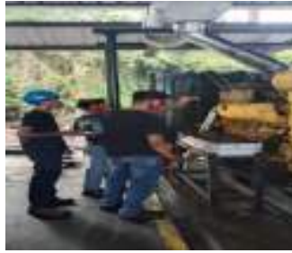
Gambar 2.15 Kegiatan monitoring KWH setiap jamnya (Sumber: PT. Megapower Makmur Tbk, 2023)
