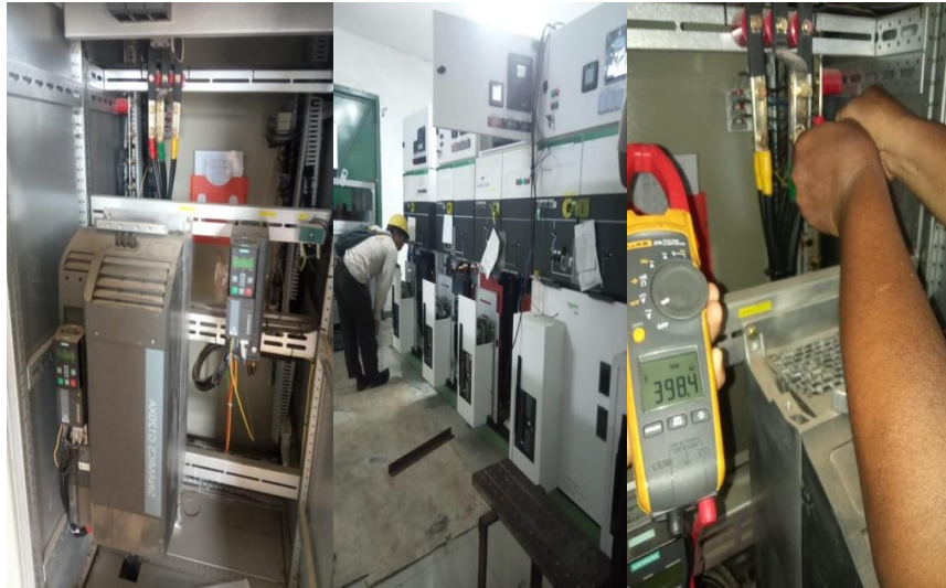
Gambar 2.6 melakukan pengukuran voltage dan ampere Sumber : Dokumen Perusahaan PT. Sari Dumai Oleo
