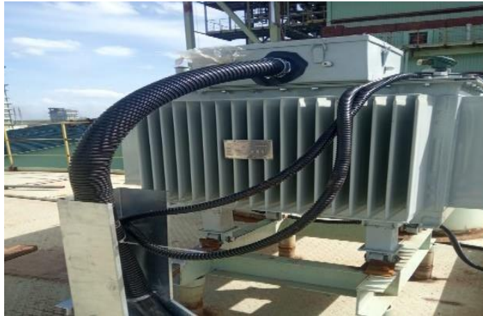
Gambar 3.8 Transformer reactifier pada ESP Sumber: Dokumentasi PT. Sari Dumai Oleo (SDS 2)
