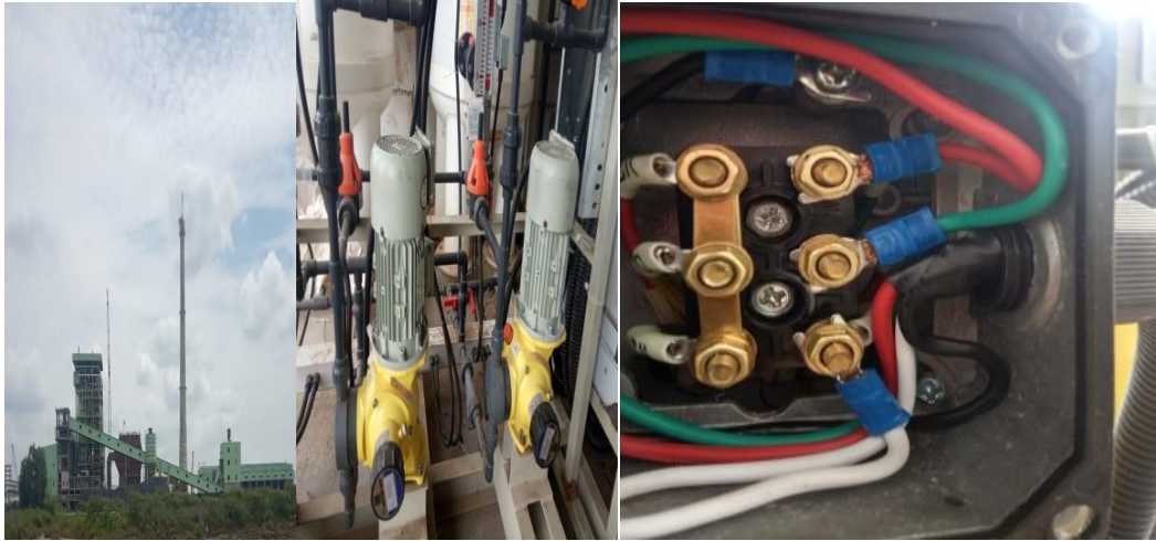
Gambar 2.5 melakukan megger motor dengan daya 0,37kw Sumber : Dokumen Perusahaan PT. Sari Dumai Oleo
