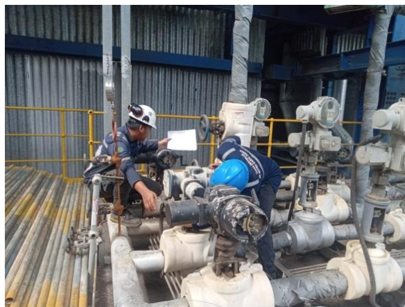
Gambar 2. 44 Proses pengecekan kerusakan pada MOV di lantai 6 (Sumber : Dokumentasi 2023)
