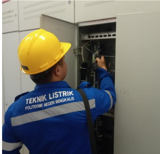
Gambar 2. 37 Proses pengecekan arus dan tegangan di Panel MCC WTP (Sumber : Dokumentasi 2023)
