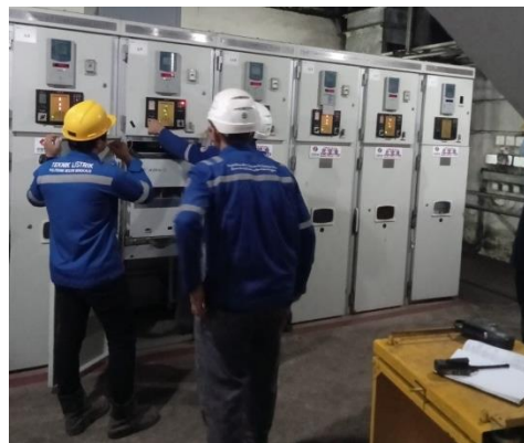
Gambar 2. 24 Proses pengecekan Panel Braker (Sumber : Dokumentasi 2023)
