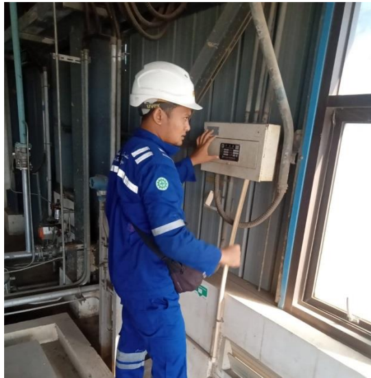
Gambar 2. 35 Proses pemutusan tegangan di Braker (Sumber : Dokumentasi 2023)
