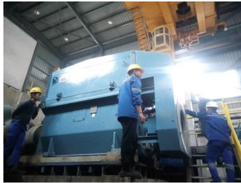
Gambar 2. 10 Proses pengecekan Cooller Motor CWP (Sumber : Dokumentasi 2023)
