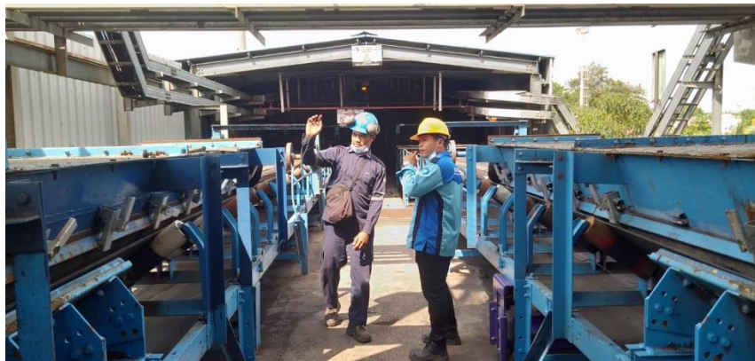
Gambar 2. 66 Belt Conveyor 01 (Sumber: Dokumentasi 2023)
