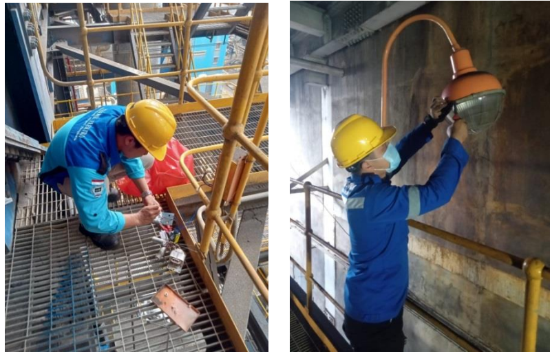
Gambar 2. 58 Penggantian Ballast dan Lampu di area Boiler
