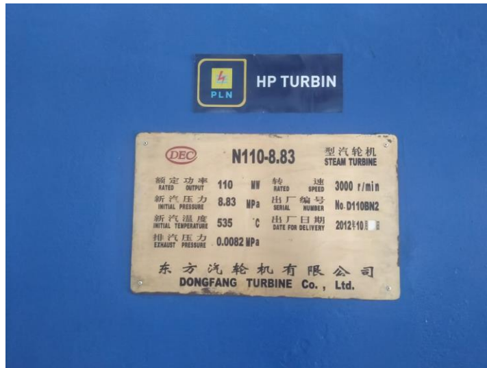
Gambar 2. 74 Name Plate Turbin (Sumber: Dokumentasi 2023)
