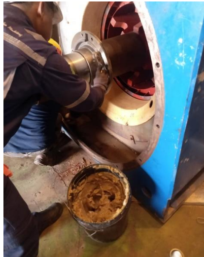
Gambar 3. 17 Pemberian Grease pada inner housing bearing (Sumber: Dokumentasi 2023)
