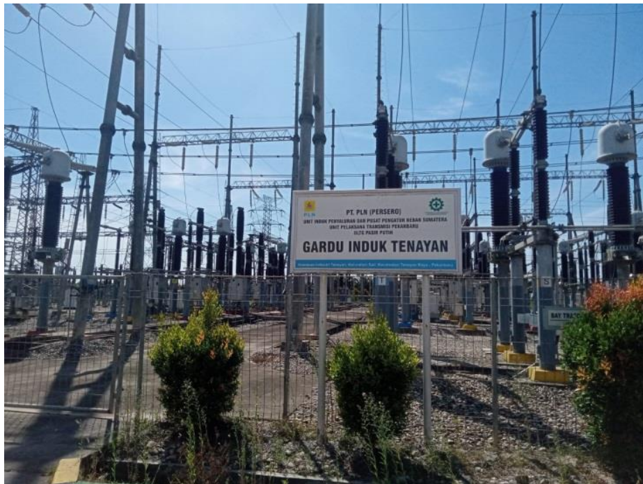
Gambar 1. 2 Gardu Induk PLTU Tenayan
