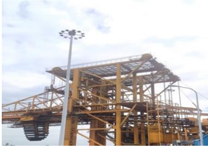
Gambar 2. 65 Ship Unloader (SU) (Sumber: Dokumentasi 2023)
