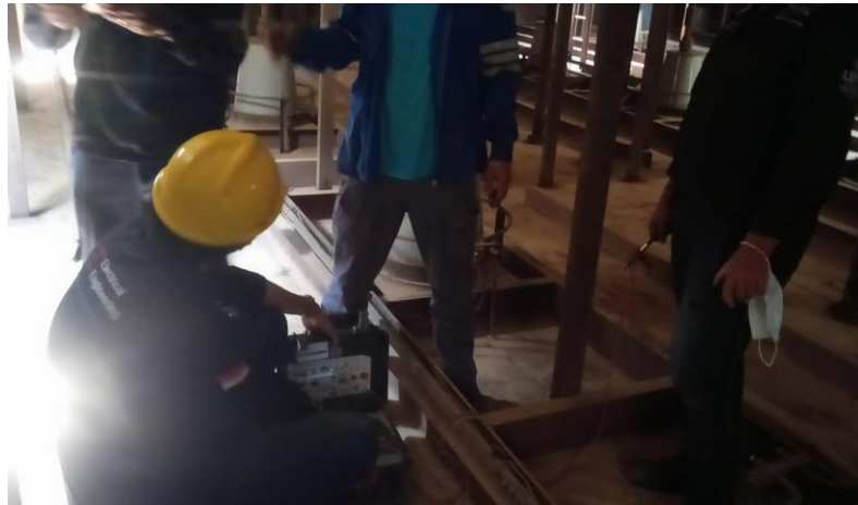
Gambar 2. 49 Proses pengukuran tahanan isolasi pada isolator esp (Sumber : Dokumentasi 2023)
