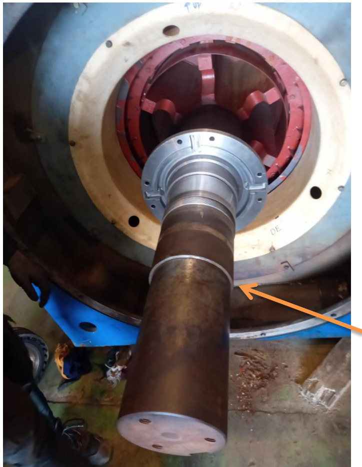
Gambar 3. 6 Main Shaft (Sumber: Dokumentasi 2023)
