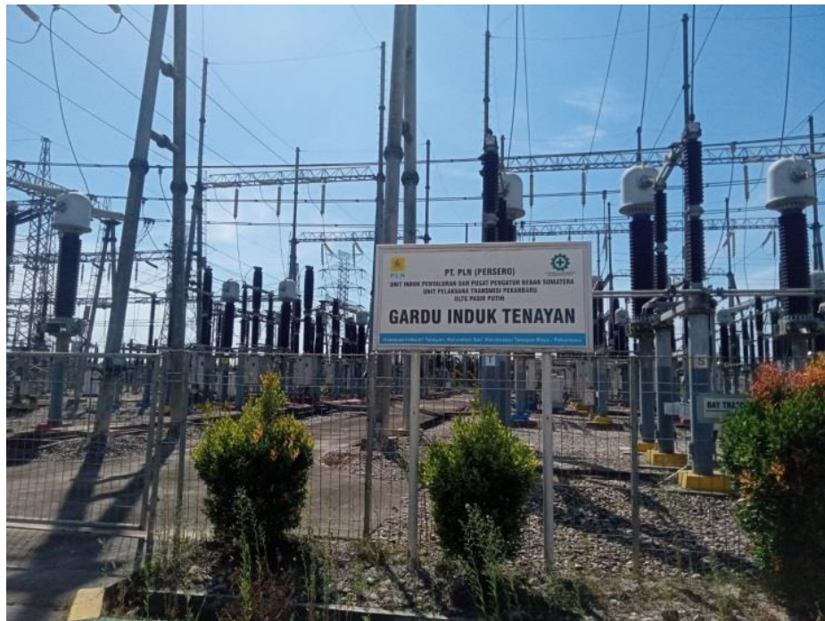
Gambar 1. 2 Gardu Induk PLTU Tenayan
