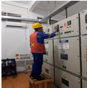
Gambar 2. 21 Pengambilan beban feeder pada gardu Sumber: PT. Adra Gemilang. 2023
