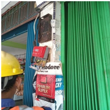
Gambar 2. 27 Perbaikan kWh meter Sumber: PT. Adra Gemilang. 2023
