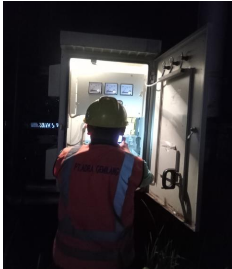
Gambar 2. 60Pengecekan trafo Sumber: PT. Adra Gemilang. 2023
