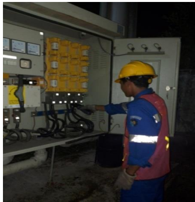
Gambar 2. 51 Pengukuran beban trafo Sumber: PT. Adra Gemilang. 2023
