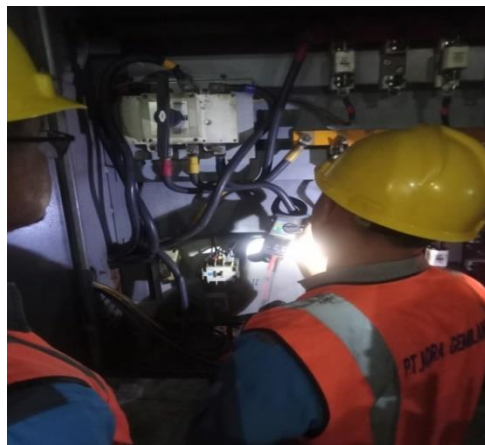
Gambar 2. 57 Pengecekan dan pengukuran beban trafo Sumber: PT. Adra Gemilang. 2023
