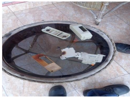
Gambar 2. 15 Penggantian MCB yang terbakar Sumber : PT. Adra Gemilang. 2023
