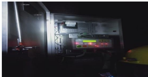
Gambar 2.58 Mengatasi gangguan RC yang trip di Penampi pada gangguan TM (tegangan menengah). ( Sumber : PT. Adra gemilang.2023)
