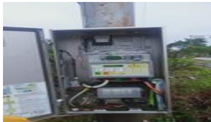
Gambar 2. 6 Pereriksa Recloser ( Sumber: PT. Adra gemilang.2023)
