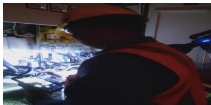
Gambar 2.31 Melakukan Pengukuran Beban Trafo ( Sumber :PLN. PT. Adra gemilang.2023
