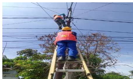
Gambar 2.22 Melakukan Penyambungkan Kabel SR yang Putus Akibat di tabrak Mobil ( Sumber : PT. Adra gemilang.2023)
