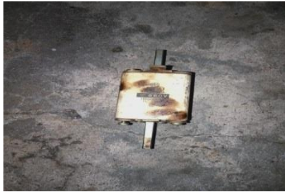
Gambar 2.51 Melakukan Pengantian NH Fuse yang Terbakar ( Sumber : PT. Adra gemilang.2023)
