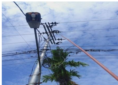
Gambar 2. 7Pengecekan FCO ( Sumber :. Adra gemilang.2023
