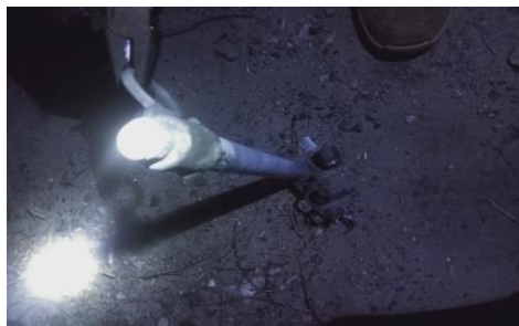
Gambar 2. 38 Melakukan pengantiaan Fuse link dengan Fuse Link yang Baru ( Sumber :PLN. PT. Adra gemilang.2023)
