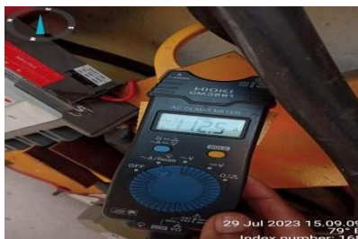
Gambar 2. 15 Pengecekan Beban Trafo (Sumber : PT. PLN (Persero) ULP Bangkinang 2023)
