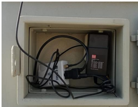
Gambar 2. 49 Pengecekan Modem (Sumber : PT. PLN (Persero) ULP Bangkinang 2023)
