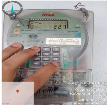
Gambar 2. 41 Pengecekan Kwh Meter (Sumber : PT. PLN (Persero) ULP Bangkinang 2023)
