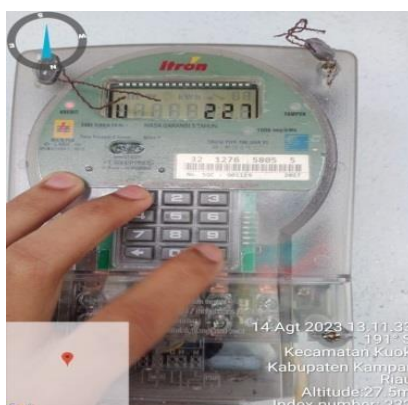
Gambar 2. 40 Pengecekan Kwh Meter (Sumber : PT. PLN (Persero) ULP Bangkinang 2023)
