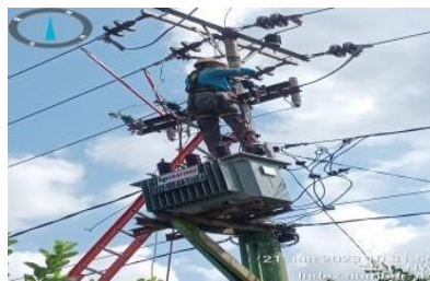
Gambar 2. 12 Pengantin FCO Trafo (Sumber : PT. PLN (Persero) ULP Bangkinang 2023)
