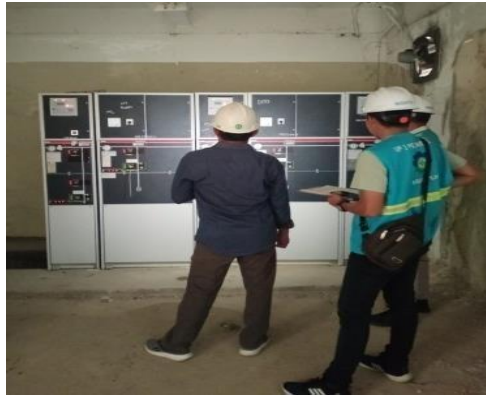
Gambar 2. 43 Pengecekan Cubicele DPRD (Sumber : PT. PLN (Persero) ULP Bangkinang 2023)
