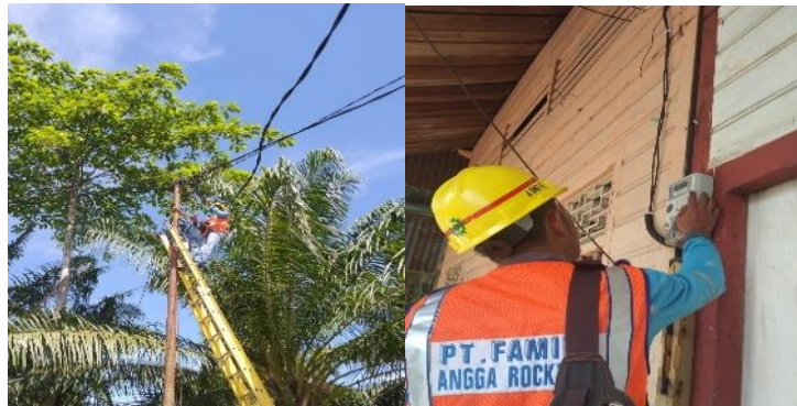
Gambar 2. 28 Mengatasi Lost Kontak Sumber: (Dokumentasi Pribadi 2023)
