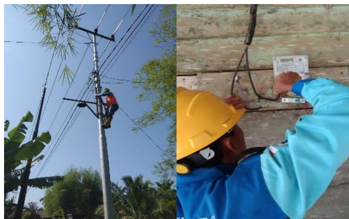
Gambar 2. 45 Mengatasi Gangguan Listrik Sumber: (Dokumentasi Pribadi 2023)
