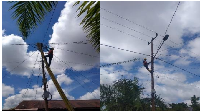
Gambar 2. 23 Mengatasi Lost Kontak Sumber: (Dokumentasi Pribadi 2023)
