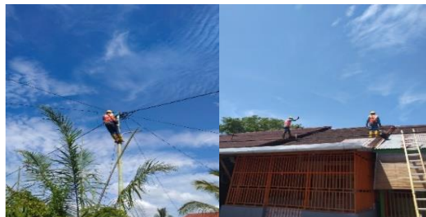
Gambar 2. 33 Mengatasi Lost Kontak Sumber: (Dokumentasi Pribadi 2023)
