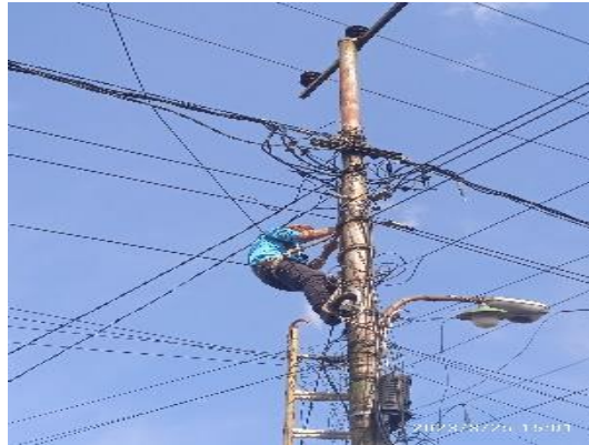
Gambar 2. 56 Mengatasi Lost Kontak Sumber: (Dokumentasi Pribadi 2023)
