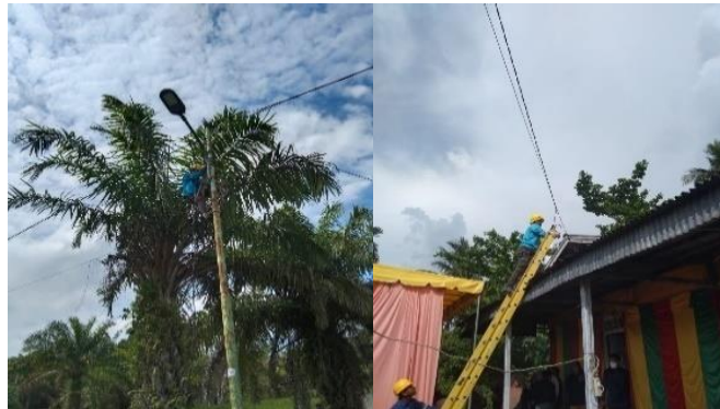
Gambar 2. 21 Mengatasi Lost Kontak Sumber: (Dokumentasi Pribadi 2023)
