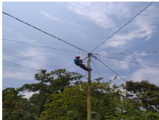
Gambar 2. 57 Mengatasi Lost Kontak Sumber: (Dokumentasi Pribadi 2023)
