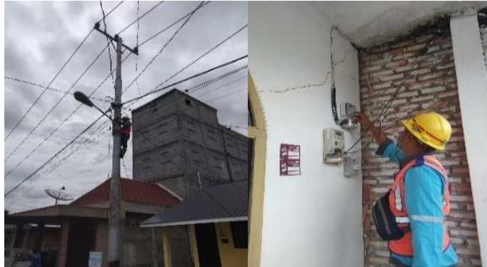
Gambar 2. 24 Mengatasi Lost Kontak Sumber: (Dokumentasi Pribadi 2023)
