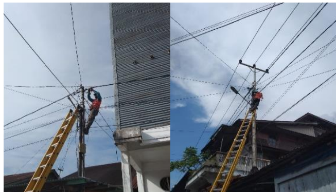
Gambar 2. 22 Penyeimbangan Pada Trafo Sumber: (Dokumentasi Pribadi 2023)
