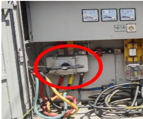
Gambar 3. 2 Saklar Utama Sumber: (Dokumentasi Pribadi 2023)
