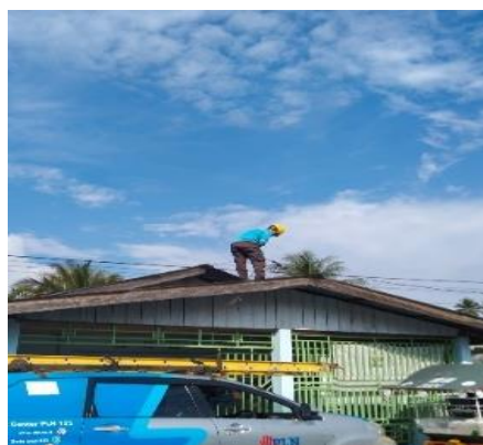
Gambar 2. 20 Mengatasi Lost Kontak Sumber: (Dokumentasi Pribadi 2023)
