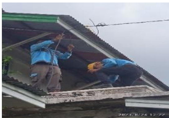
Gambar 2. 55 Mengatasi Lost Kontak Sumber: (Dokumentasi Pribadi 2023)
