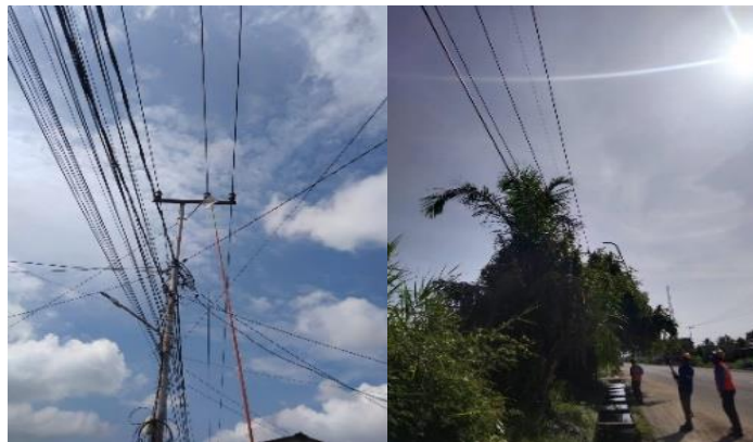
Gambar 2. 25 Mengatasi Lost Kontak Sumber: (Dokumentasi Pribadi 2023)
