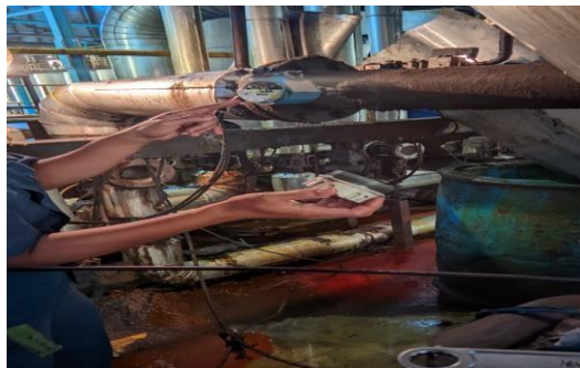
Gambar 2.16 Level transmitter Sumber: (Dokumentasi, 2023)
