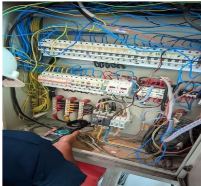
Gambar 2.23 Pengecekan MCB dengan multitester Sumber: (Dokumentasi, 2023)
