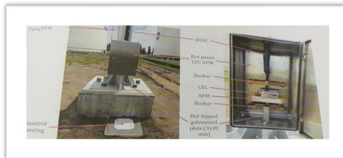
Gambar 3.8 Box sistem monitoring LPS (Sumber : Dokumentasi, 2023)
