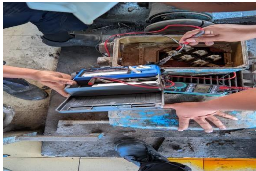
Gambar 2.22 Pengecekan motor dengan multitester Sumber: (Dokumentasi, 2023)
