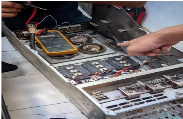
Gambar 2.15 Inverter Sumber: (Dokumentasi, 2023)
