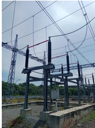
Gambar 3. 7 Pemisah (Disconnecting Switch) (Sumber :Dokumentasi,2023)
