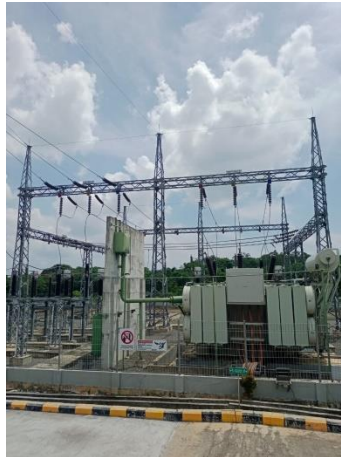
Gambar 3. 1 Gardu Induk (Sumber :Dokumentasi penulis)
