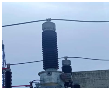
Gambar 2. 5 Current Voltage Transformer (sumber :dokumentasi penulis)
