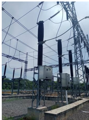
Gambar 2. 9 Circuit Breaker (sumber :dokumentasi penulis)
