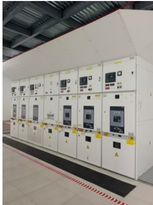
Gambar 3. 8 Panel Hubung 20 kv (Sumber :Dokumentasi,2023)
