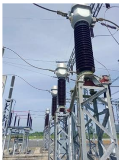
Gambar 2. 12 Current Transformer Line Trafo ( sumber :dokumentasi penulis)
