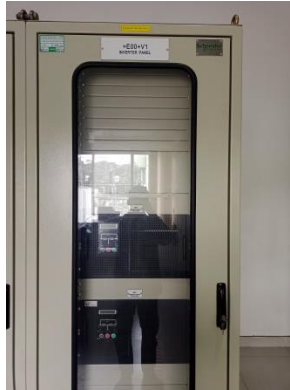
Gambar 2. 21 Panel Inverter (sumber :dokumentasi penulis)
