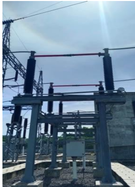
Gambar 2. 6 Disconnecting Switch Earthing (sumber :dokumentasi penulis)
