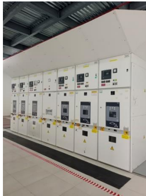
Gambar 2. 17 Kubikel 20 Kv (sumber :dokumentasi penulis)
