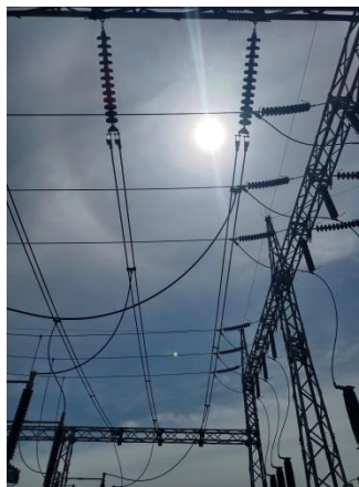
Gambar 3. 9 Busbar (Sumber :Dokumentasi,2023)
