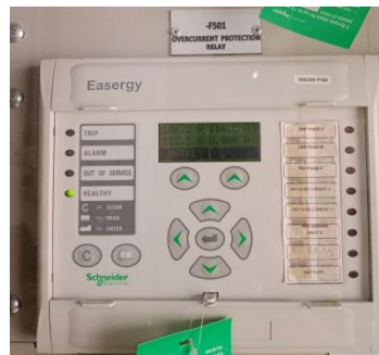
Gambar 2. 27 Overcurrent Relay Line Trafo (sumber :dokumentasi penulis)
