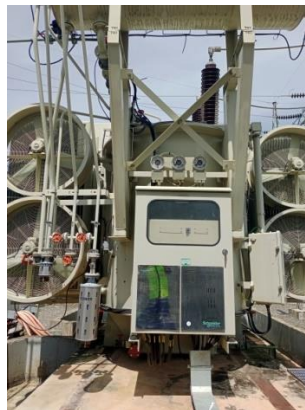
Gambar 2. 16 Transformator (sumber :dokumentasi penulis)
