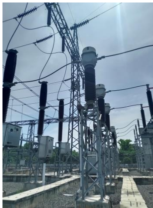
Gambar 2. 8 Current Transformer (sumber :dokumentasi penulis)
