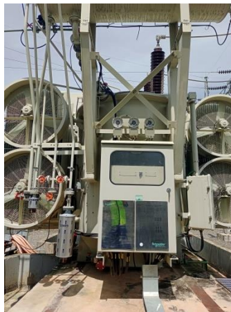
Gambar 3. 2 Transformer (Sumber :Dokumentasi,2023)
