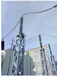
Gambar 2. 11 Lightning Arrester Line Trafo (sumber :dokumentasi penulis)
