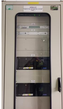
Gambar 2. 23 Panel 1 Substation Automation System (sumber:dokumentasi penulis)
