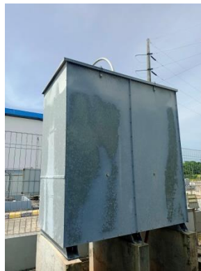
Gambar 2. 15 Netral Grounding Resistan (sumber :dokumentasi penulis)
