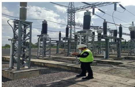
Gambar 2. 2 Perkenalan Peralatan Gardu Induk (sumber : dokumentasi penulis)
