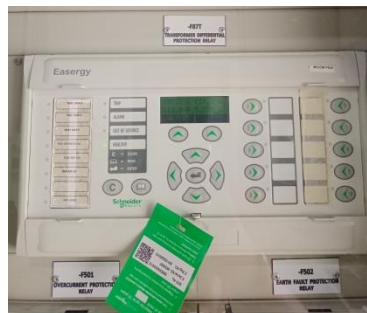
Gambar 2. 26 Differential Relay Line Trafo (sumber :dokumentasi penulis)
