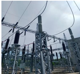
Gambar 2. 4 lightning arrester (sumber:dokumentasi penulis)
