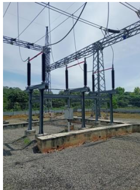
Gambar 2. 14 Disconnecting Switch Line Trafo (sumber :dokumentasi penulis)
