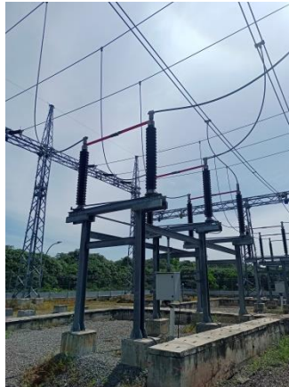
Gambar 2. 10 Disconnecting Switch (sumber :dokumentasi penulis)
