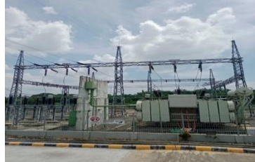
Gambar 2. 3 Pemahaman Alat Switchgear ( sumber : dokumentasi penulis)
