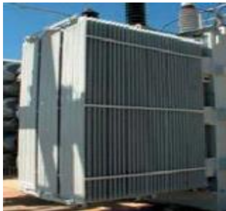
Gambar 3.5 Pendingin pada transformator
