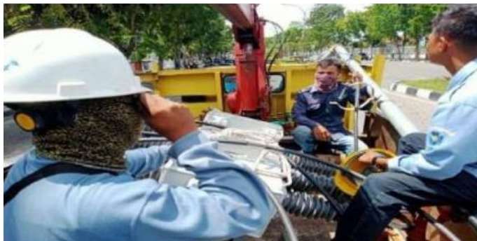
Gambar 2.10 Pemindahan LBS Sumber: Dokumentasi, 2022
