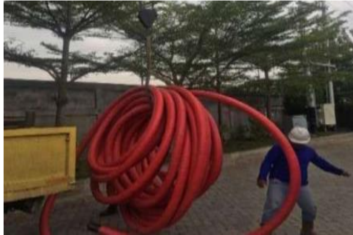
Gambar 2.6 Kabel Tanah Sumber: Dokumentasi, 2022
