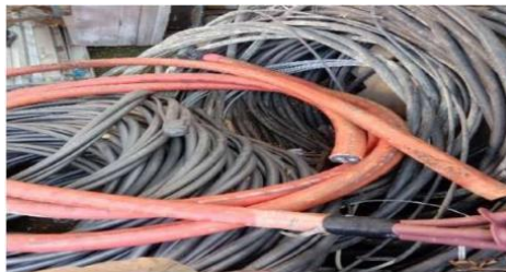
Gambar 2.28 Kabel Tanah Sumber: Dokumentasi, 2022
