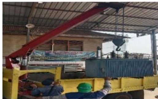
Gambar 2.3 Muat Trafo Sumber: Dokumentasi, 2022
