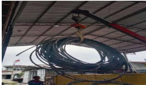
Gambar 2.33 Penimbangan Kabel Sumber: Dokumentasi, 2022
