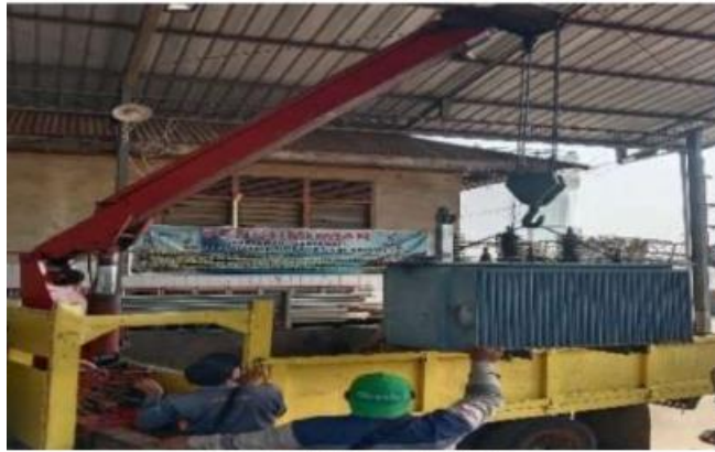
Gambar 2.38 Muat Trafo Sumber: Dokumentasi, 2022
