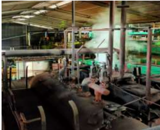
Gambar 2. 24 Peninjauan Komponen Boiler Sumber dokumentasi 2023
