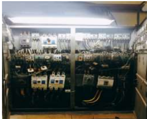
Gambar 2. 33 memeriksa Panel Stasiun Power Plant Sumber Dokumentasi 2023
