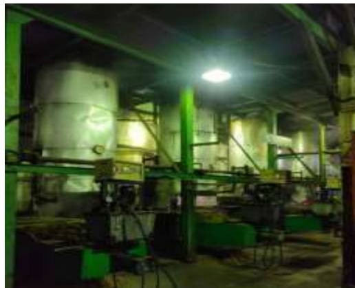
Gambar 2. 5 Stasiun Press Sumber dokumentasi 2023
