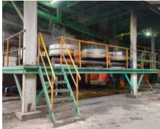
Gambar 2. 6 Stasiun Clarification Sumber dokumentasi 2023
