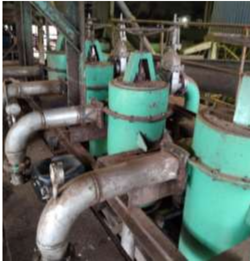
Gambar 2. 24 Hydrocyclone Sumber (Dokumentasi 2023)
