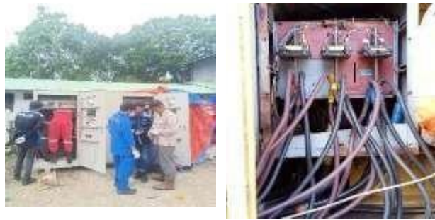
Gambar 2. 4 Tes kemampuan genset menggunakan load bank (Sumber : Dokumentasi 2022)
