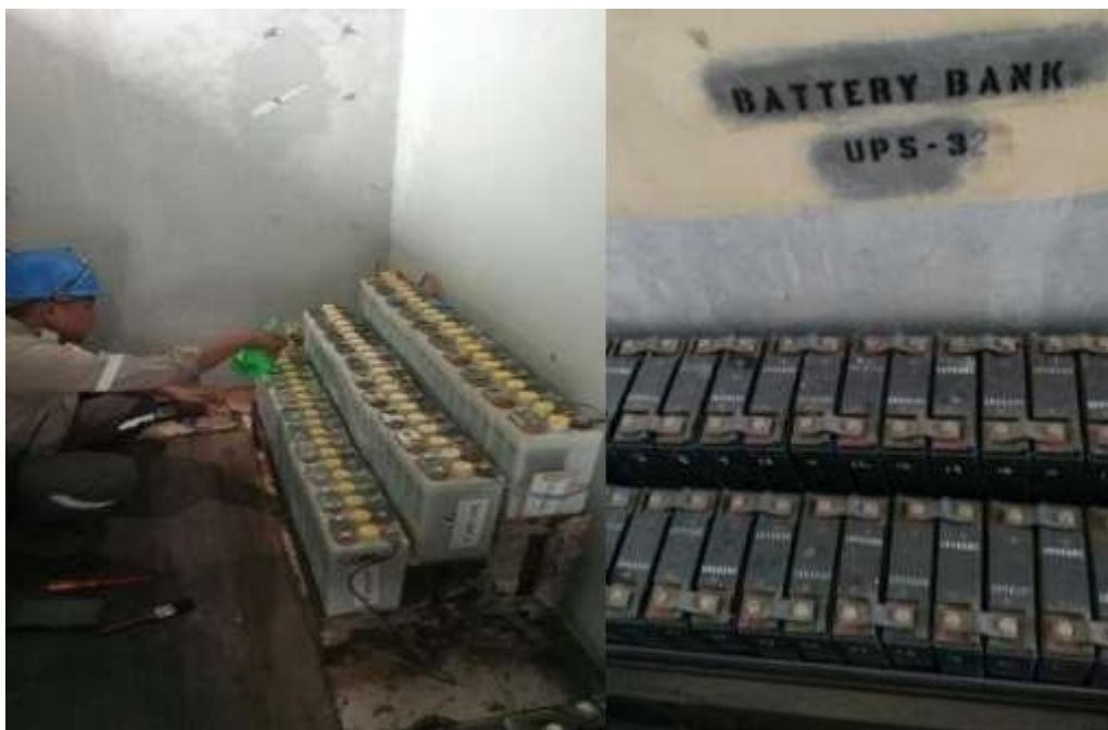
Gambar 2. 2 Monitoring kondisi batrai (Sumber : Dokumentasi 2022)
