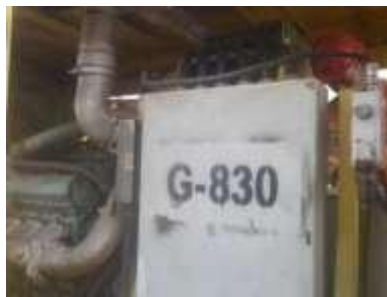
Gambar 2. 3 Pemeliharaan emergency genset (Sumber : Dokumentasi 2022)
