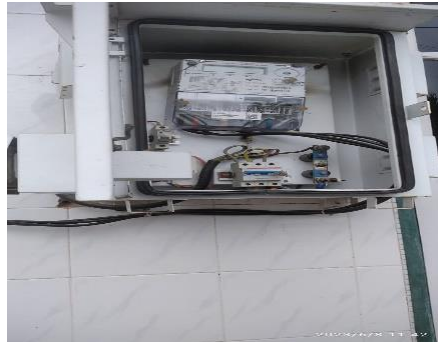
Gambar 2.5 Memperbaiki Masalah Kehilangan Satu Fasa S pada Kwh Meter 3 Fasa (Sumber PT. Haleyora Power 2023)
