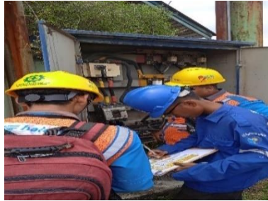
Gambar 2.37 Inpeksi gardu dan pentanahan pada trafo (Sumber PT. Haleyora Power 2023)
