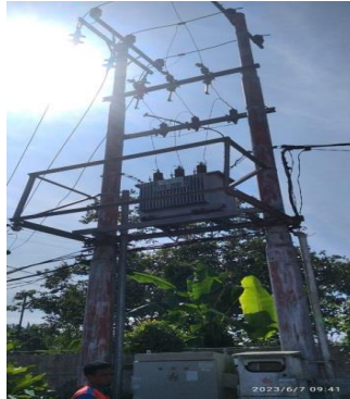
Gambar 3.2 Lokasi Pemasangan Panel PHB-TR (Sumber Olahan Data 2023)
