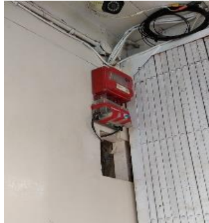
Gambar 2.6 Mengganti kwh meter 1 phasa yang terbakar pada terminalnya ke kwh meter sementara atau dummy (Sumber PT. Haleyora Power 2023)
