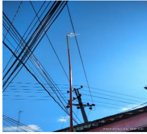
Gambar 2.10 Pembersihan layang-layangan dari jaringan SUTM (Sumber PT. Haleyora Power 2023)
