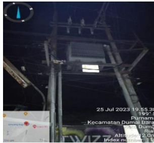
Gambar 2.34 Inpeksi Beban Trafo dan Tegangan Ujung (Sumber PT. Haleyora Power 2023)
