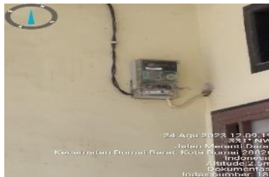
Gambar 2.55 kwh meter 1 phasa tidak bisa masuk token (Sumber PT. Haleyora Power 2023)
