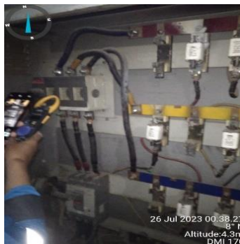
Gambar 2.35 Pengecekan beban trafo dan tegangan ujung (Sumber PT. Haleyora Power 2023)
