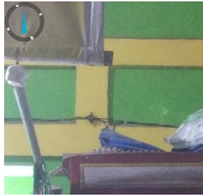
Gambar 2.48 Percing Lost Kontak atau percing longgar (Sumber PT. Haleyora Power 2023)
