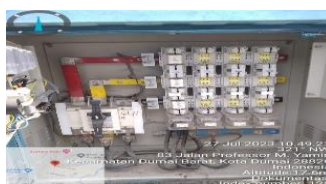
Gambar 2.36 Inpeksi Gardu dan pengecekan kondisi trafo (Sumber PT. Haleyora Power 2023)
