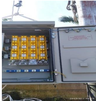
Gambar 3.1 Panel Perlengkapan Hubung Bagi Tegangan Rendah (PHB-TR) (Sumber Olahan Data 2023)
