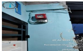
Gambar 2.30 Mengganti Kwh meter 1 fasa Error ke kwh meter 1 fasa sementara atau dummy (Sumber PT. Haleyora Power 2023)
