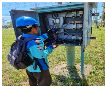
Gambar 2.40 Inpeksi Gardu menggunakan aplikasi freemobile pln untuk Worker Order (Sumber PT. Haleyora Power 2023)
