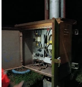
Gambar 2.24 Pengambilan Data Digardu Distribusi di Desa Bantan Tengah Sumber: (Dokumentasi, 2023)
