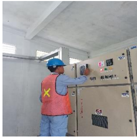
Gambar 2.26 Pengambilan Data Feeder Gardu Hubung di Desa Selat Baru Sumber: (Dokumentasi, 2023)
