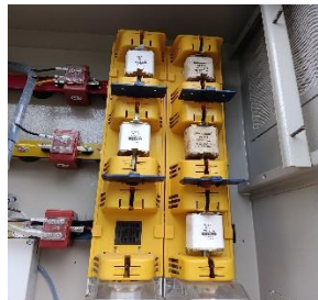
Gambar 2.35 Pengambilan Data Digardu Distribusi di Desa Bantan Tengah Sumber: (Dokumentasi, 2023)
