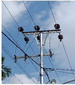
Gambar 2.28 Pengontrolan FCO (Fuse Cutout) di Desa Bantan Tengah Sumber: (Dokumentasi, 2023)
