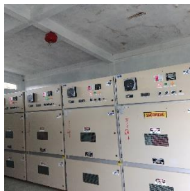
Gambar 2.22 Pengambilan Data Feeder Gardu Hubung Desa Selat Baru Sumber: (Dokumentasi, 2023)
