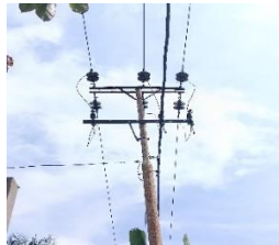
Gambar 2.21 Pengotrolan FCO ( Fuse Cutout ) di Desa Bantan Tengah Sumber: (Dokumentasi, 2023)
