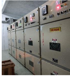
Gambar 2.17 Pengambilan Data Feeder Gardu Hubung di Desa Selat Baru Sumber: (Dokumentasi, 2023)
