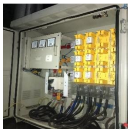
Gambar 2.20 Pengambilan Data Digardu Distribusi di Desa Bantan Tengah Sumber: (Dokumentasi, 2023)
