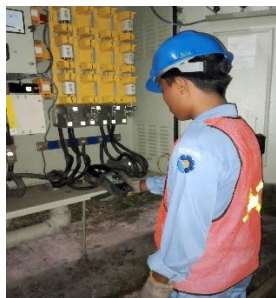
Gambar 2.16 Pengambilan Data Digardu Distribusi di Desa Bantan Tengah
