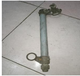
Gambar 2.23 Pengontrolan FCO (Fuse Cutout) di Desa Bantan Tengah Sumber: (Dokumentasi, 2023)
