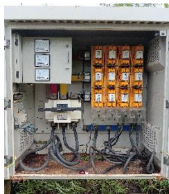
Gambar 2.4 Infeksi Gardu Distribusi PHB-TR di Desa Pematang Duku Sumber: (Dokumentasi, 2023)
