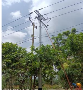
Gambar 2.5 Pengotrolan FCO (Fuse Cutout) di Desa Pematang Duku Sumber: (Dokumentasi, 2023)
