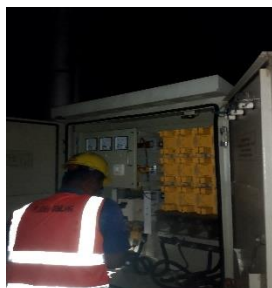
Gambar 2.25 Pengambilan Data Digardu Distribusi di Desa Bantan Tengah Sumber: (Dokumentasi, 2023)
