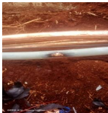
Gambar 3.1 kabel power 13,8 kv.
