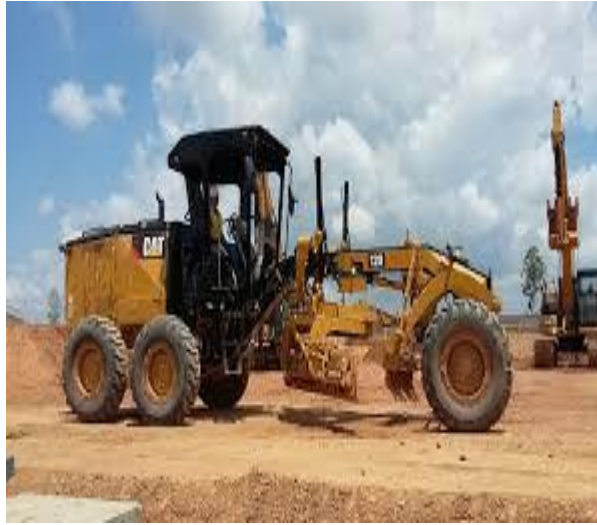
Gambar 3.26 Motor Grader (Sumber : Dokumentasi Lapangan)
