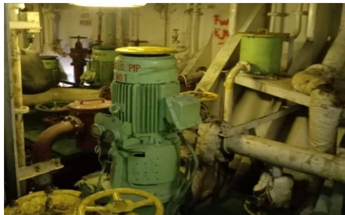
Gambar 2.12 Pemeriksaan pompa minyak pelumas
