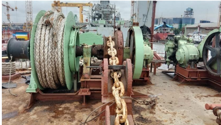
Gambar 2.52 Pemeriksaan mooring winch
