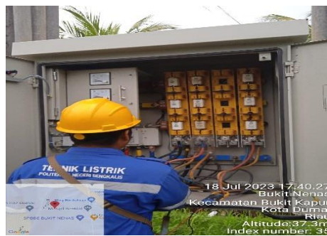
Gambar.2.29. Penyimbangan beban trafo (Sumber PT.Haleyora Power,2023)
