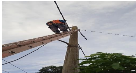
Gambar.2.30. Kabel SR jatuh
