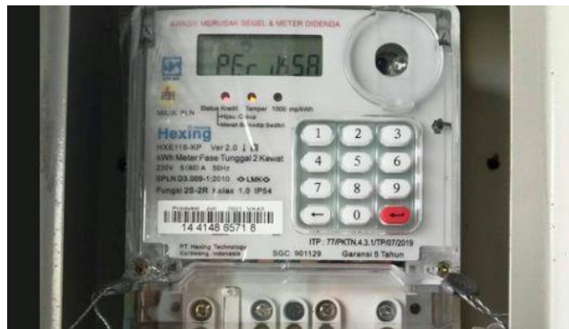
Gambar 3. 3 Kwh Meter “Periksa”
