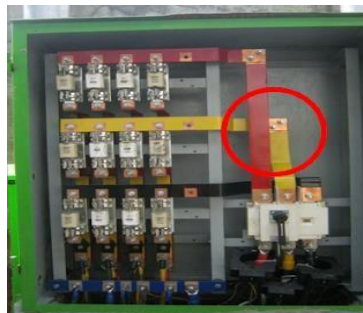
Gambar 3. 5 Rel tembaga PHB TR
