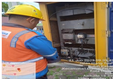
Gambar 2. 4 Penyeimbangan beban trafo
