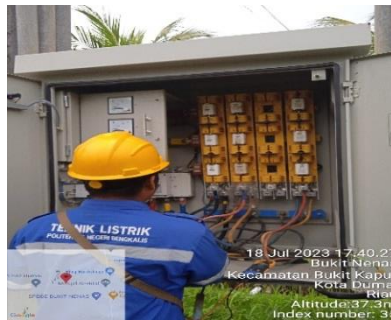
Gambar 2. 29 Penyeimbangan beban trafo.
