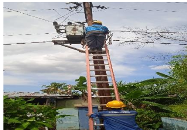
Gambar 2. 44 Memperbaiki SKTR terbakar
