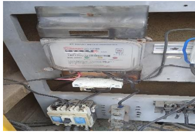
Gambar 2. 25 Mengatasi gangguan KWH
