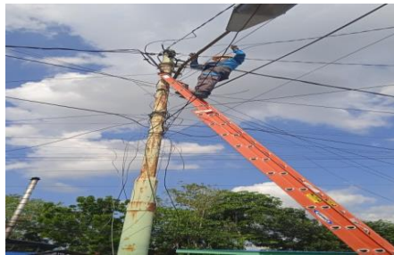
Gambar 2. 2 Gangguan pelanggan penyambungan kabel SR
