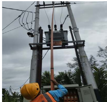
Gambar 2.33. Perbaikan fuse link pada tabung holder CO Sumber : PLN PT. Adra gemilang 2023
