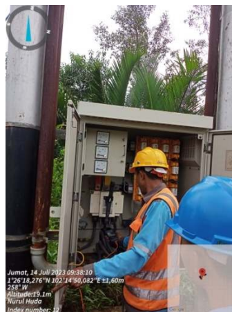
Gambar 2.4 inspeksi gardu distribusi/ PHBTR
